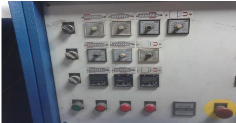
Anexo 8. Parte exterior del tablero de mando. Fuente: los autores.
