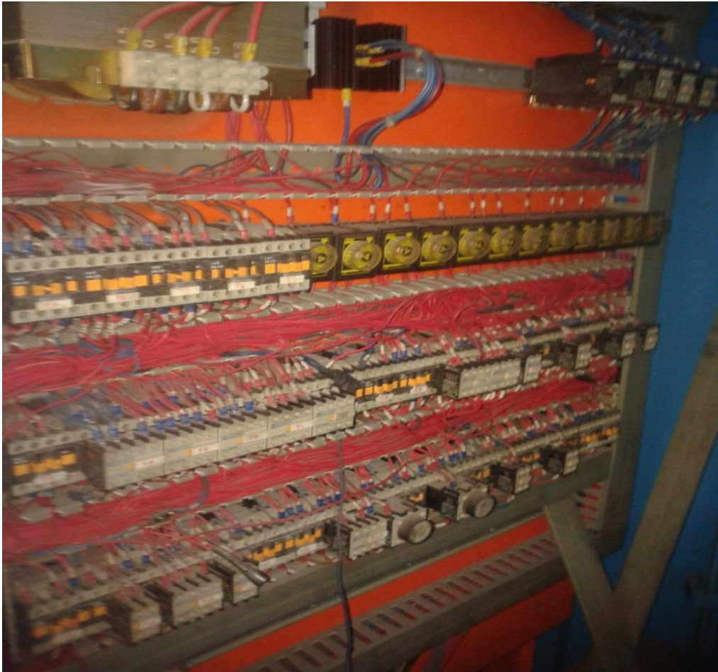
Anexo 3. Estado del cableado original de la máquina. Fuente: autores
