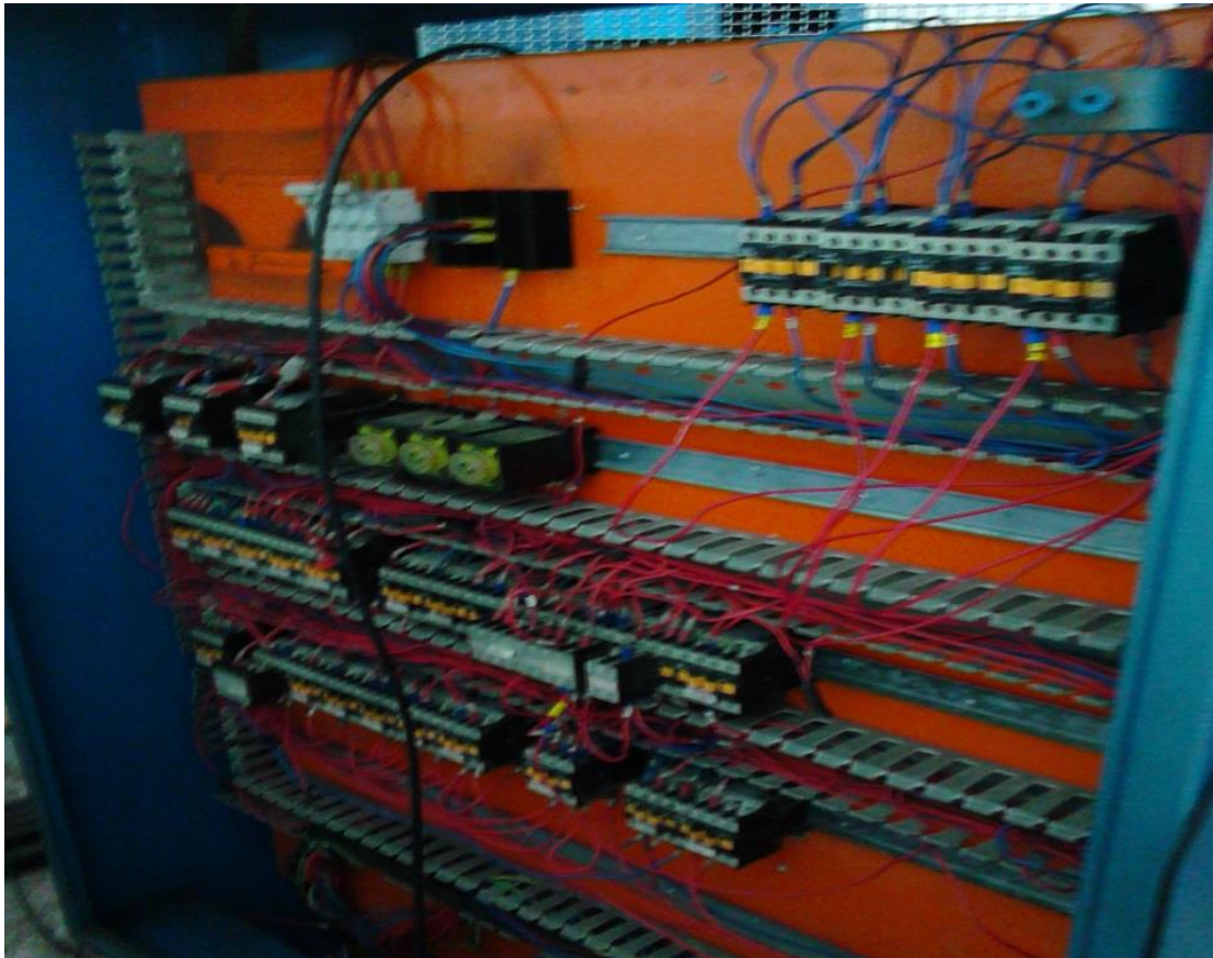
Anexo 4. Estado original del cableado, dispositivos de maniobra y elementos auxiliares.
