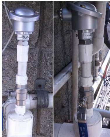
Figura 3.5. Sensor PT100 + Transmisor Siemens TH100
