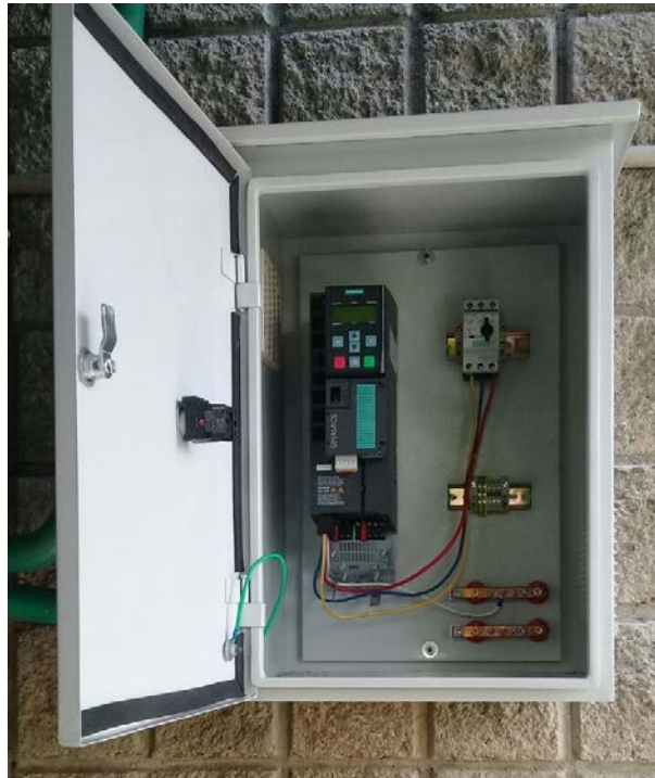
Figura 3.6. Gabinete de control variador de velocidad
