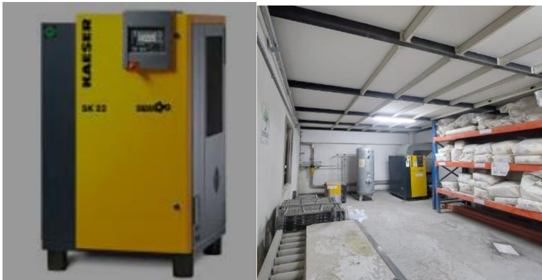
Figura 4. Compresor Kaeser 10 hp (derecha). Cuarto de compresión en planta MAPEI (Izquierda).
