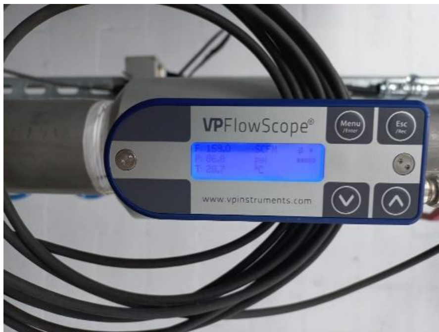
Figura 7. Medidores de flujo en línea para medida de SCFM (Vp flow in line). Fuente: autor
