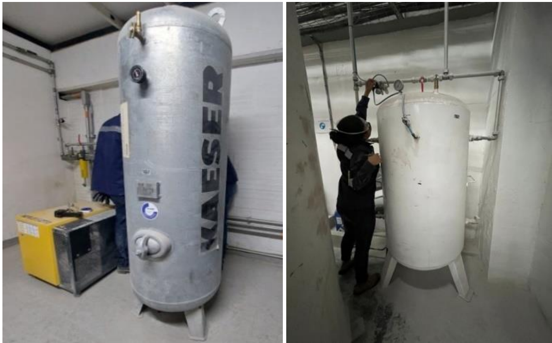
Figura 11. Tanque húmedo entre compresor y secador (izquierda), Tanque color blanco lateral a entrada cuarto de herramientas (derecha). Fuente: autor
