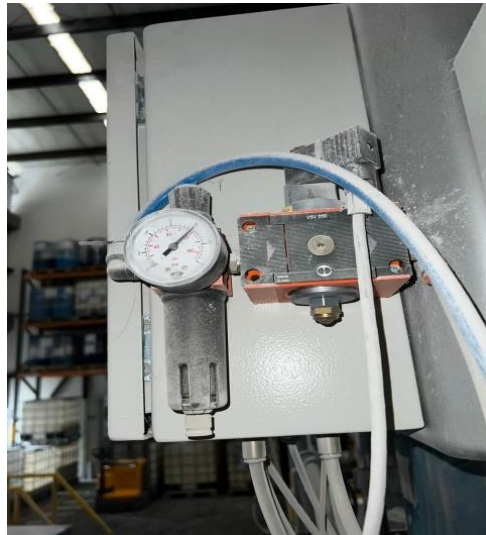
Figura 12. Unidad de Mantenimiento zona de almacenamiento y bodega.
