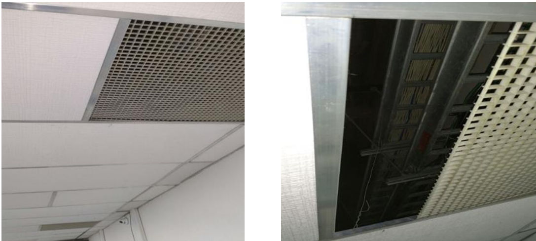
Figura 33. Escape en el retorno del sistema de aire acondicionado. Fuente: Autor
