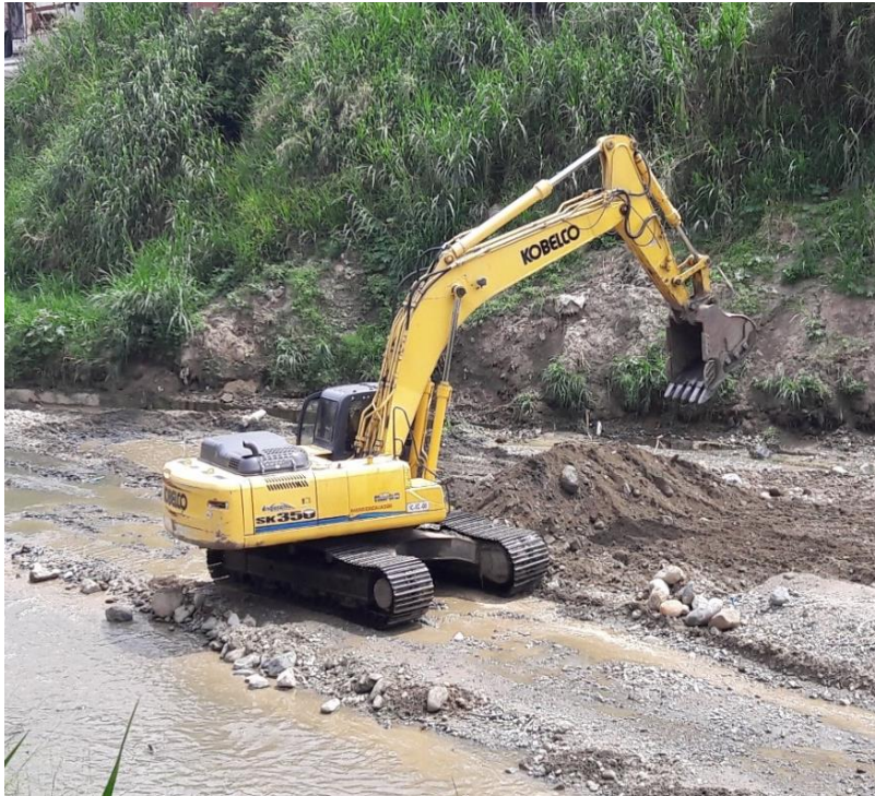
Figura 2. Excavadora KOBELCO SK350LC IC-EC-07 en el frente de obra quebrada La iguaná, Marzo 2019 INGECON S.A.S.
