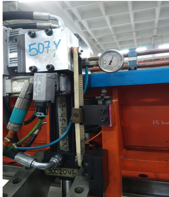
Ilustración 3. Presión del aceite. Servo válvulas estación 5 COSMA
