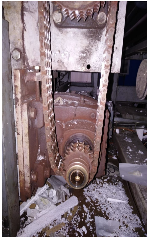
Ilustración 39. Sistema de transmisión banda transportadora fin de línea (Cassioli)
