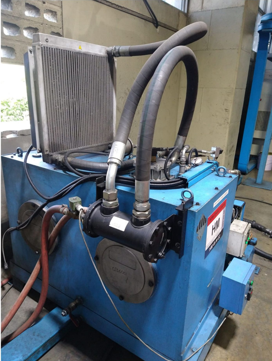
Ilustración 17. Unidad de elevación de presión hidráulica COSMA Gabinetes Fuente (autor)
