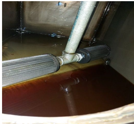
Ilustración 6. interior Tanque hidráulico
