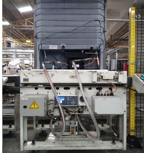
Ilustración 20. Bahía de bomba de vacío
