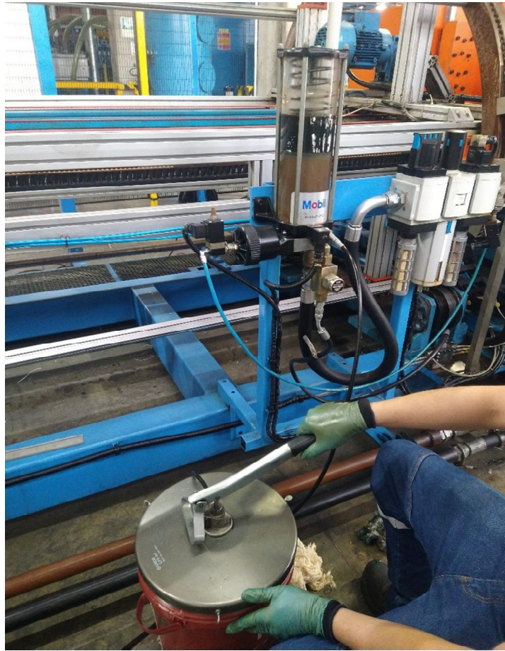
Ilustración 34. Reposición de nivel de grasa unidad de lubricación automática COSMA
