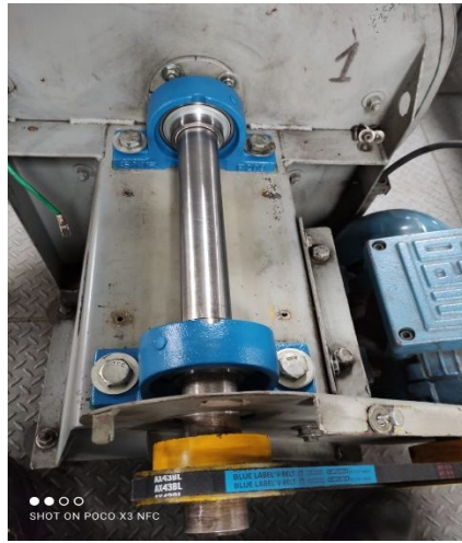
Ilustración 1. Chumaceras ducto de extracción de gas R-600
