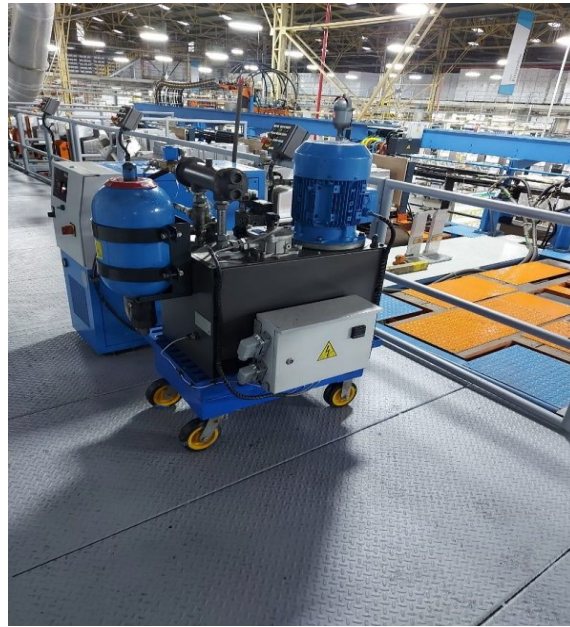
Ilustración 7. Unidad hidráulica completa espumado gabinetes planta 1
