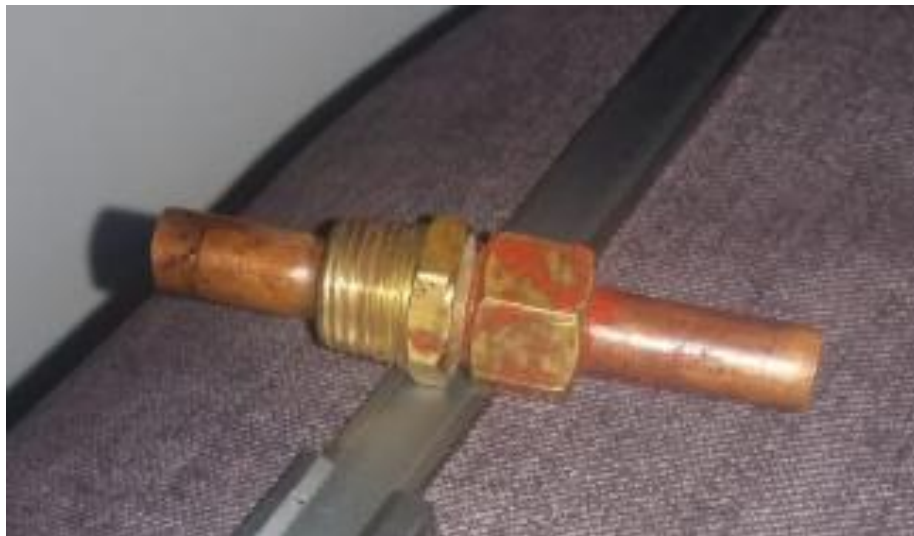
Figura 14 Apertura de uno de los termosifones para el análisis del fluido en su interior
