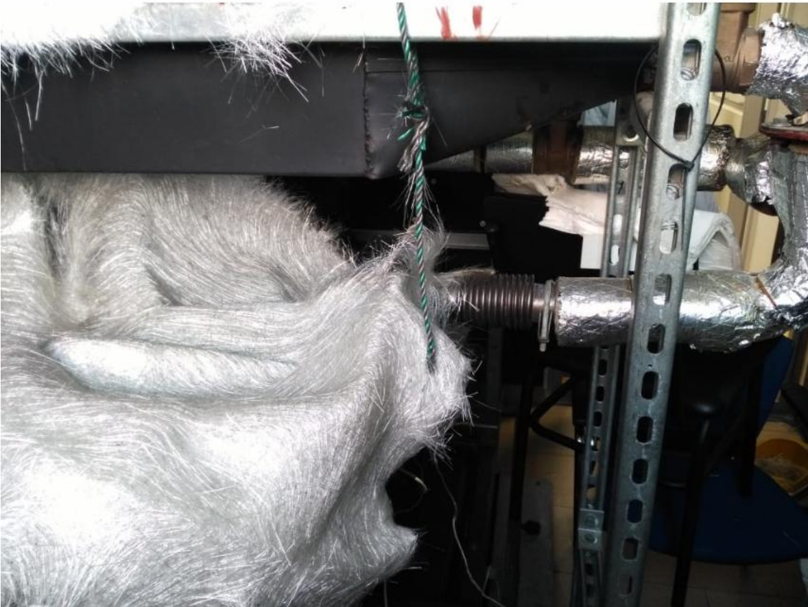
Figura 10 Falla del método de fijación del aislamiento en la carcasa del intercambiador
