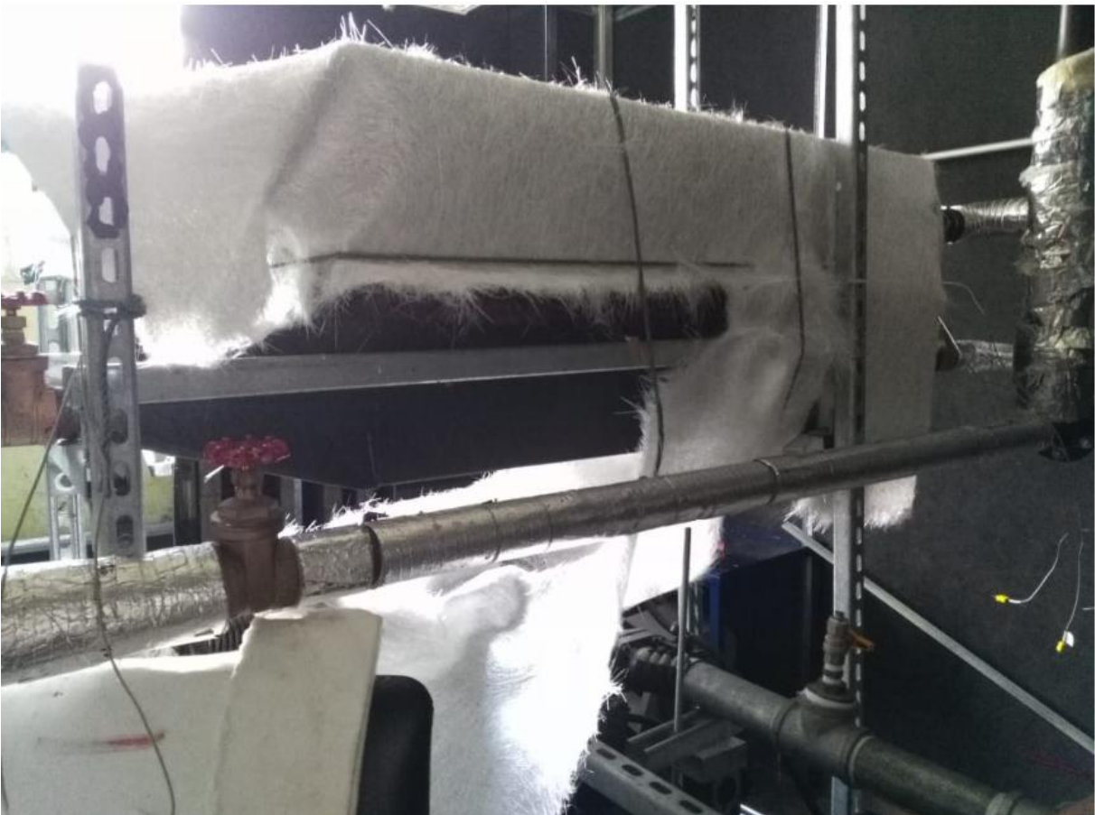
Figura 11 Vista lateral de la falla del método de fijación del aislamiento en la carcasa del intercambiador
