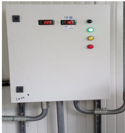
Figura 7. Tablero de control de equipos de frío
