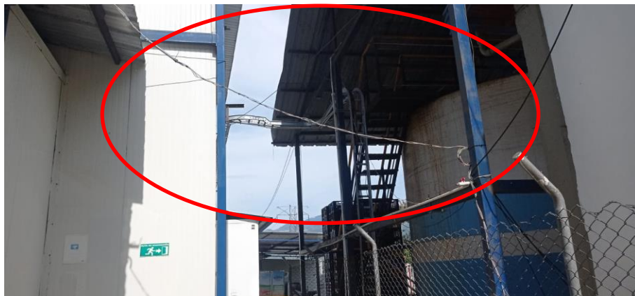
Figura 2. Condiciones técnicas que no cumplen con RETIE
