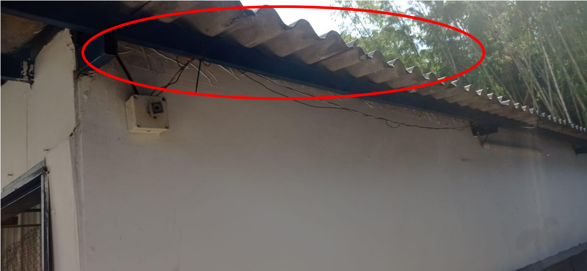
Figura 3. Cableado expuesto sin cumplimiento de norma
