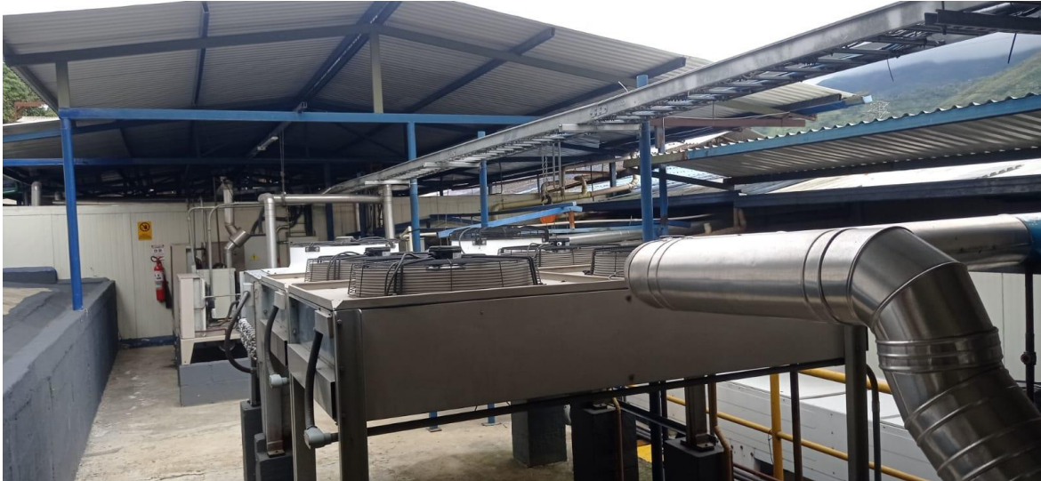
Figura 5. Condensadores de equipos de frío
