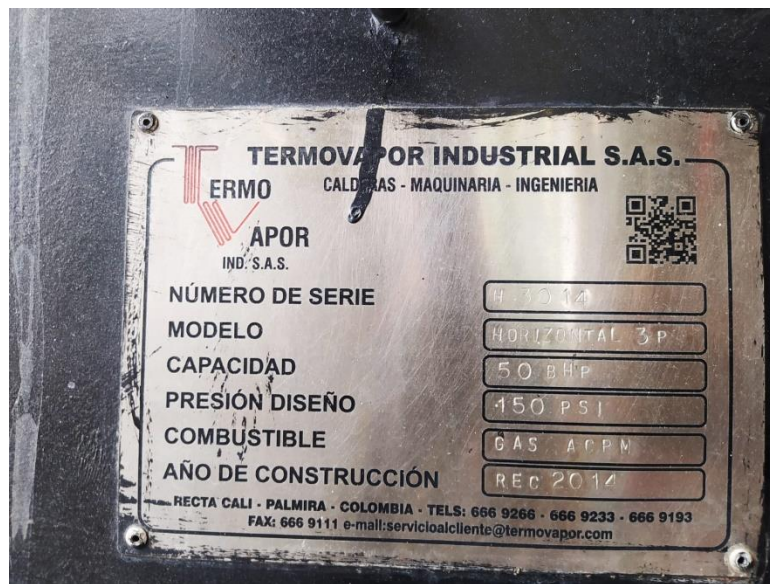
Figura 9. Placa de caldera principal
