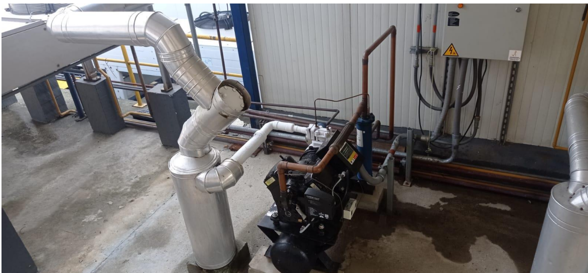
Figura 6. Compresor de equipos de frío
