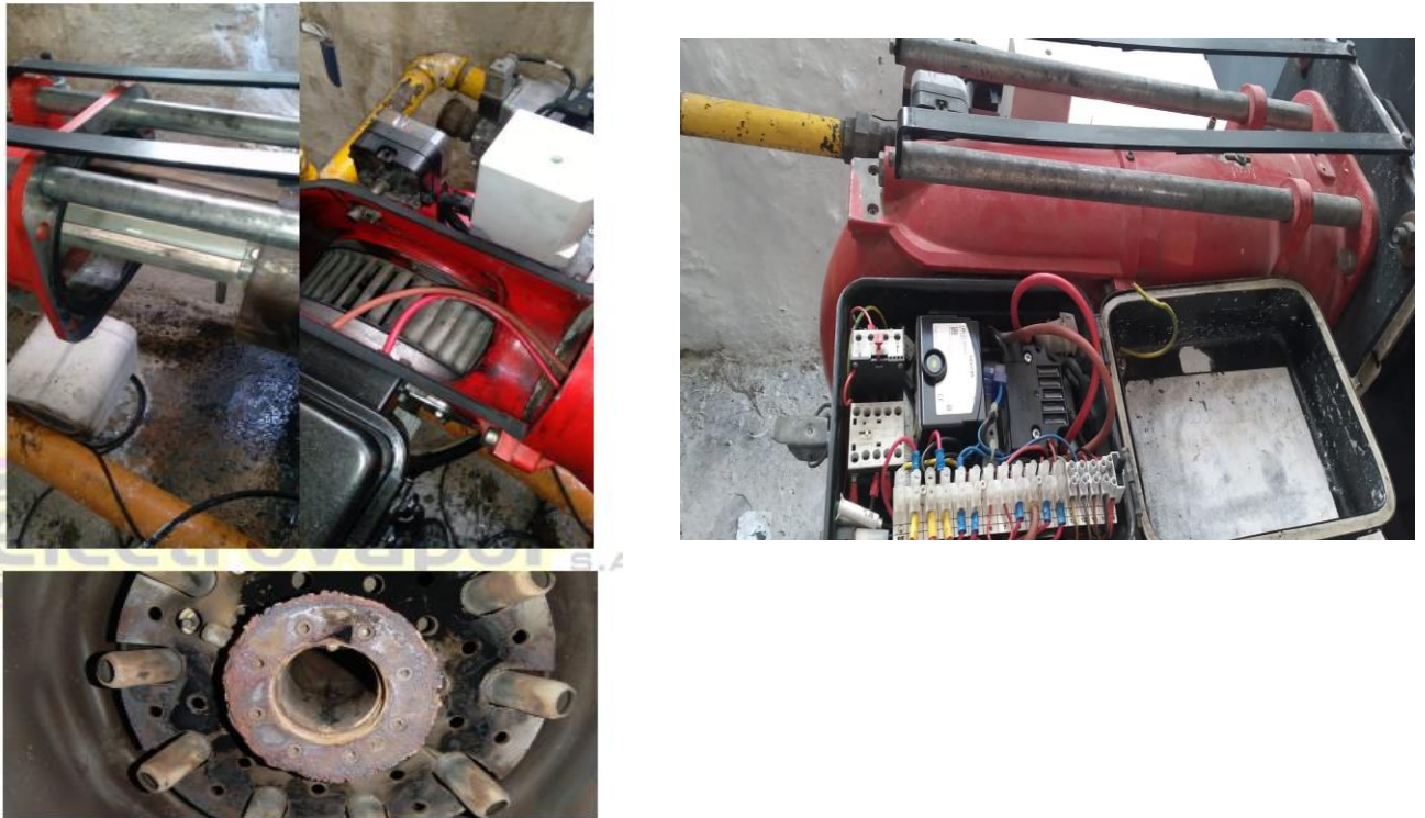
Figura 14. Quemador de caldera principal
