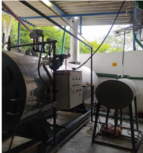
Figura 15. Tanque de suministro de agua.
