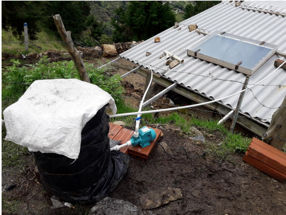
Figura 17. Sistema del colector solar empalmado.
