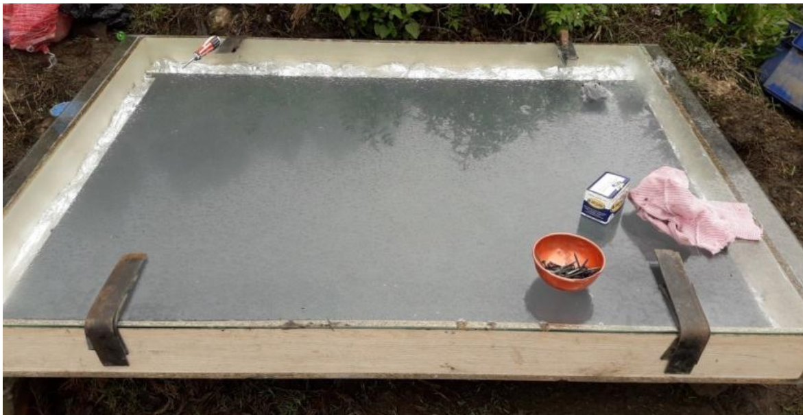
Figura 16. Colector solar terminado
