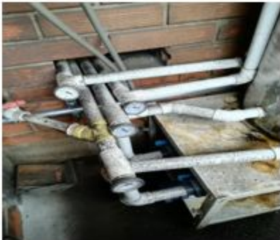
Tubería y presostatos de fluido(agua)
