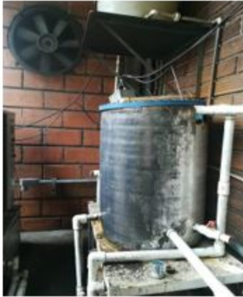
Tanque de distribución agua refrigerada
