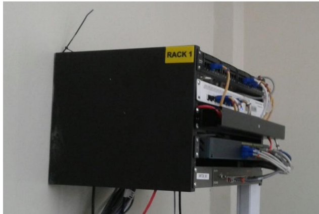
Figura 5. Rack donde está ubicado N601
