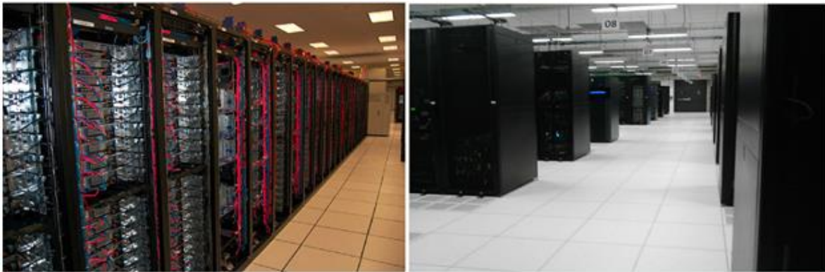
Figura 2. Centro de Datos Real. Fuente: (Bancolombia, 2014)
