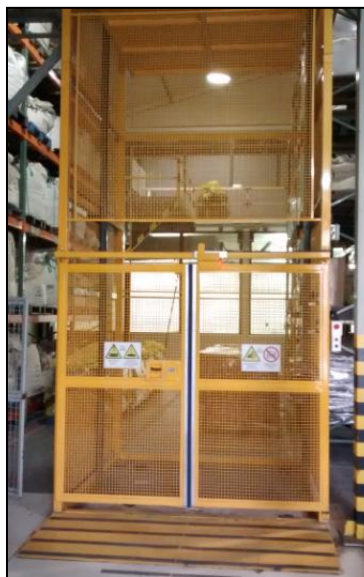
Figura N° 8: Elevador de carga
