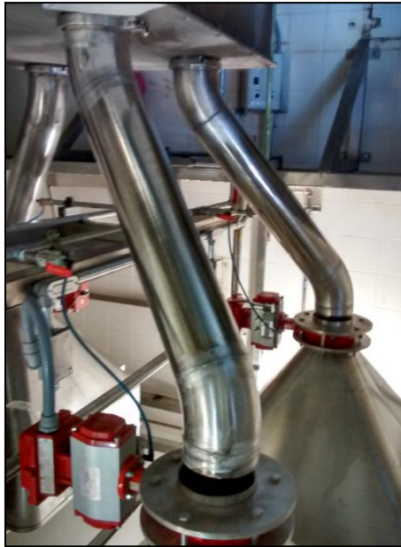
Figura N° 10: Aumento de inclinación en ductos
