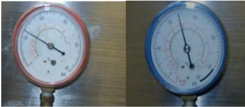
Figura 10 Manómetros de alta y baja presión.
