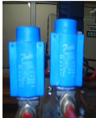
Figura 11 válvulas solenoide Danfoss.
