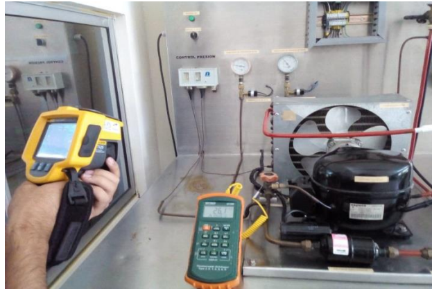
Figura 30 Análisis con cámara termografica.
