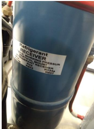
Figura 12 Depósito de refrigerante.
