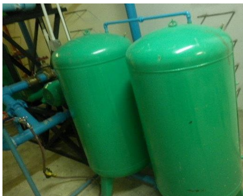
Figura44: Tanque Pulmón (hidroflow). Fuente: Elaboración propia
