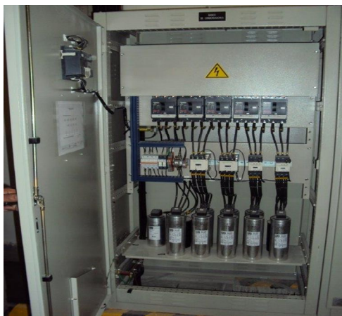
Figura30: Banco de condensadores. Fuente: Elaboracion propia
