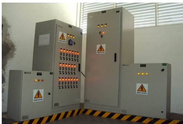
Figura 29: tableros de distribución general. Fuente: Elaboracion propia
