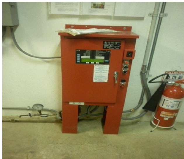
Figura 42 Tablero de control de la red contraincendios. Fuente: Elaboracion propia
