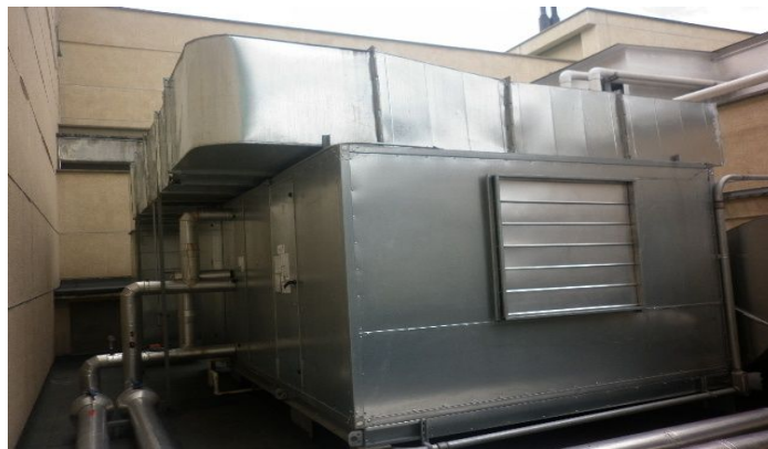
Figura33: Unidad manejadora de aire (UMA). Fuente: Elaboracion propia
