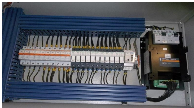
Figura32: Control automatismo. Fuente: Elaboración propia
