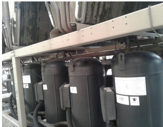
Figura 34: Chiller enfriado por aire. Fuente: Elaboracion propia
