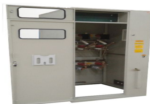
Figura 13: Celdas de seccionador. Extraído de
