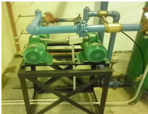
Figura 43: Bomba de Agua potable. Fuente: Elaboracion propia
