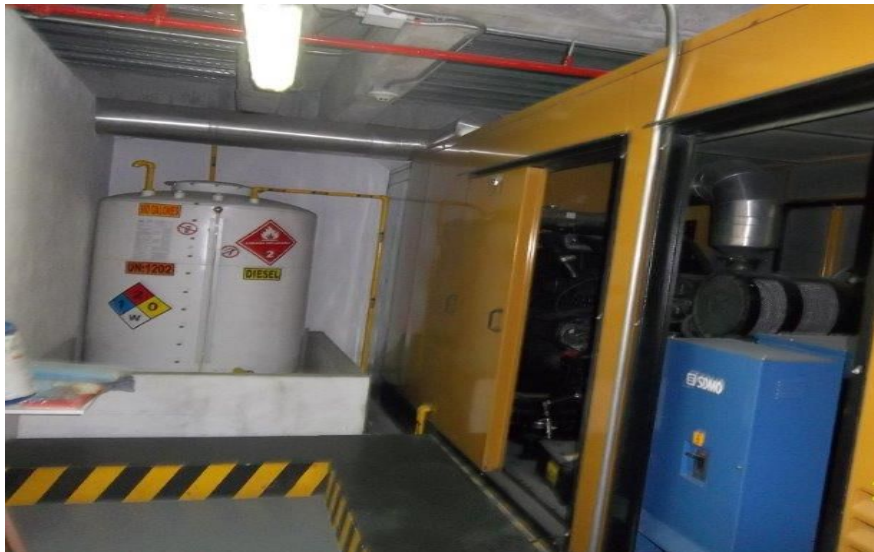
Figura 27: Tanque de almacenamiento. Fuente: elaboración propia
