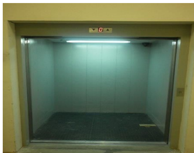
Figura 40: Cabina del ascensor de carga. Fuente: Elaboracion propia
