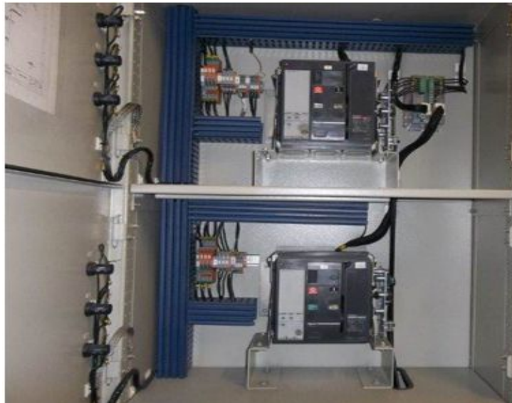
Figura 31: Contactores Motorizados (red Normal/emergencia). Fuente: Elaboración propia
