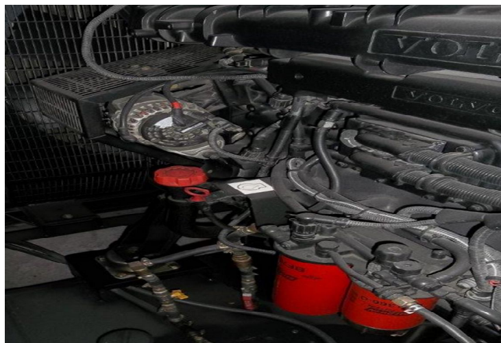
Figura 26: Motor de planta eléctrica. Fuente: elaboración propia
