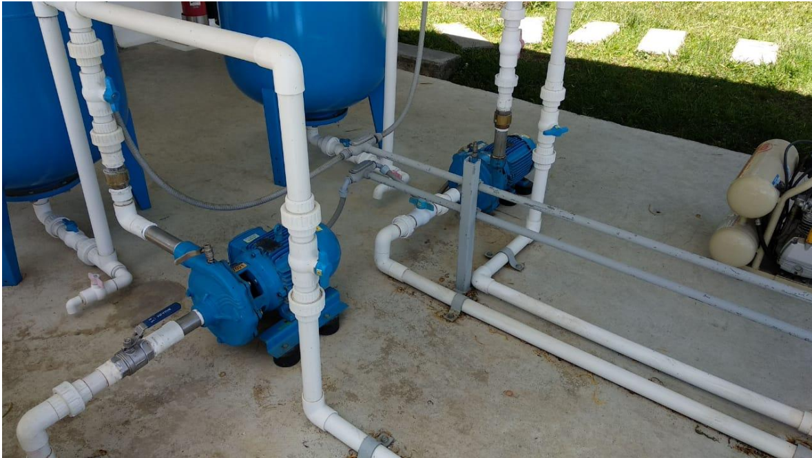
Imagen 10. Conexiones hidráulicas y eléctricas de las bombas de agua (fuente: autor)
