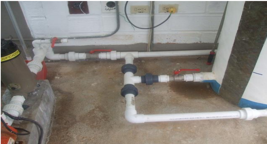
Imagen 28. Válvulas y Alimentación Eléctrica (fuente: Autor)
