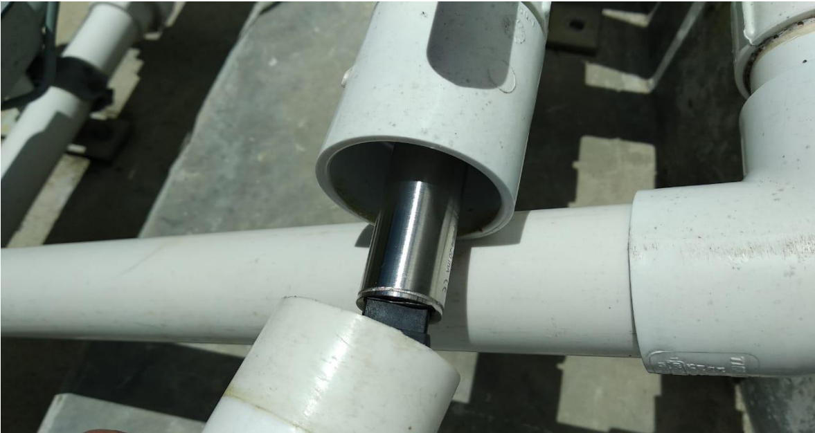
Imagen 13. Transmisor de nivel (fuente: autor)
