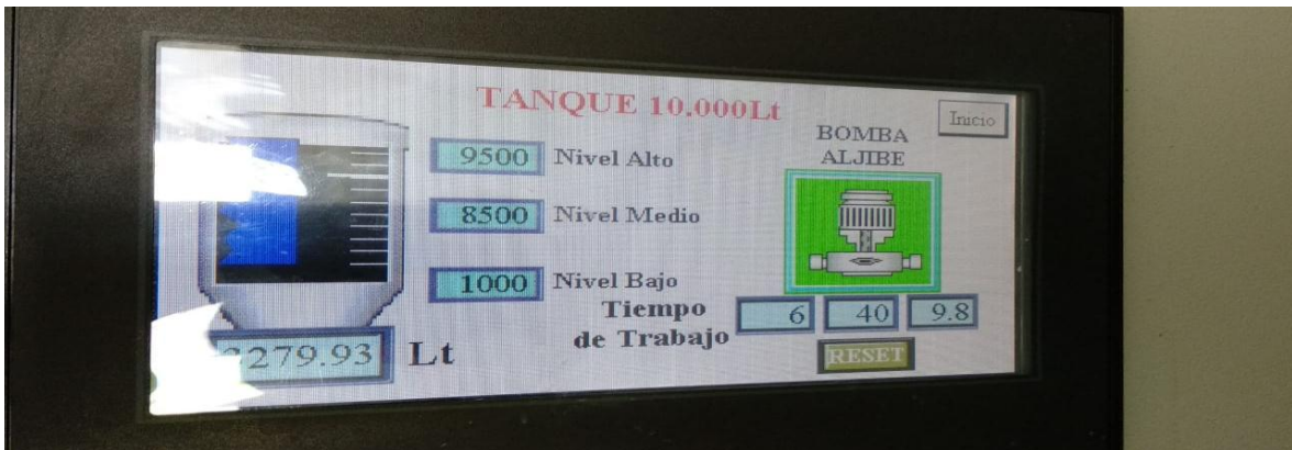
Imagen 21. Página de control tanque 10m 3 PTAP (fuente: autor)
