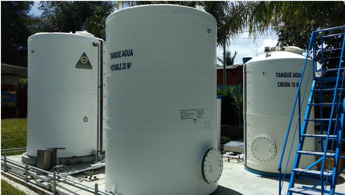
Imagen 12. Tanques de almacenamiento (fuente: autor)
