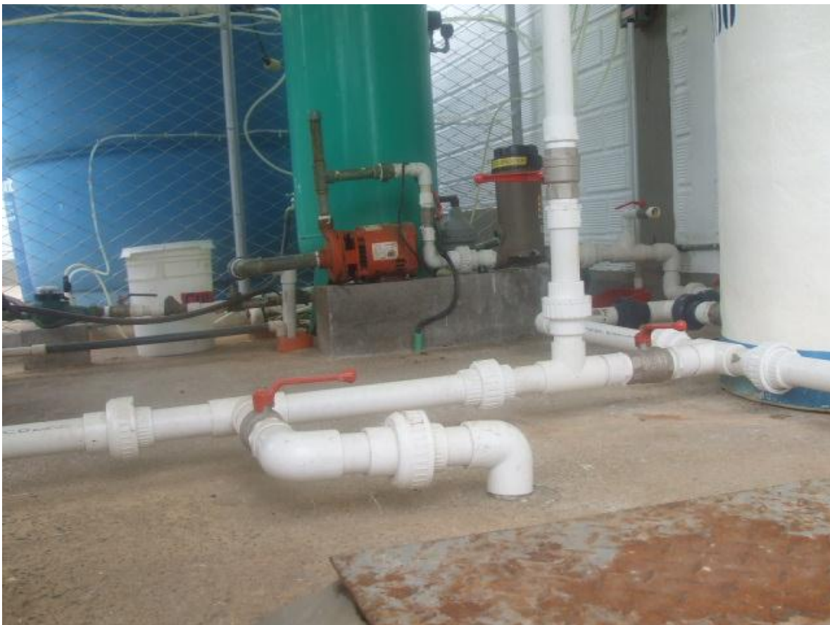
Imagen 29. Sensor de Flujo y Bomba (fuente: Autor)
