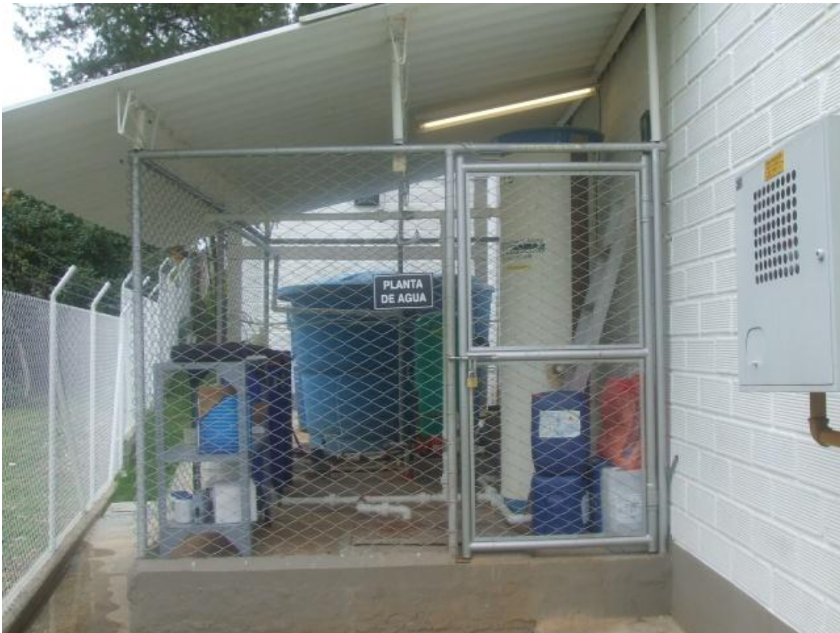
Imagen 25. PTAP antes de la Automatización (fuente: Autor)
