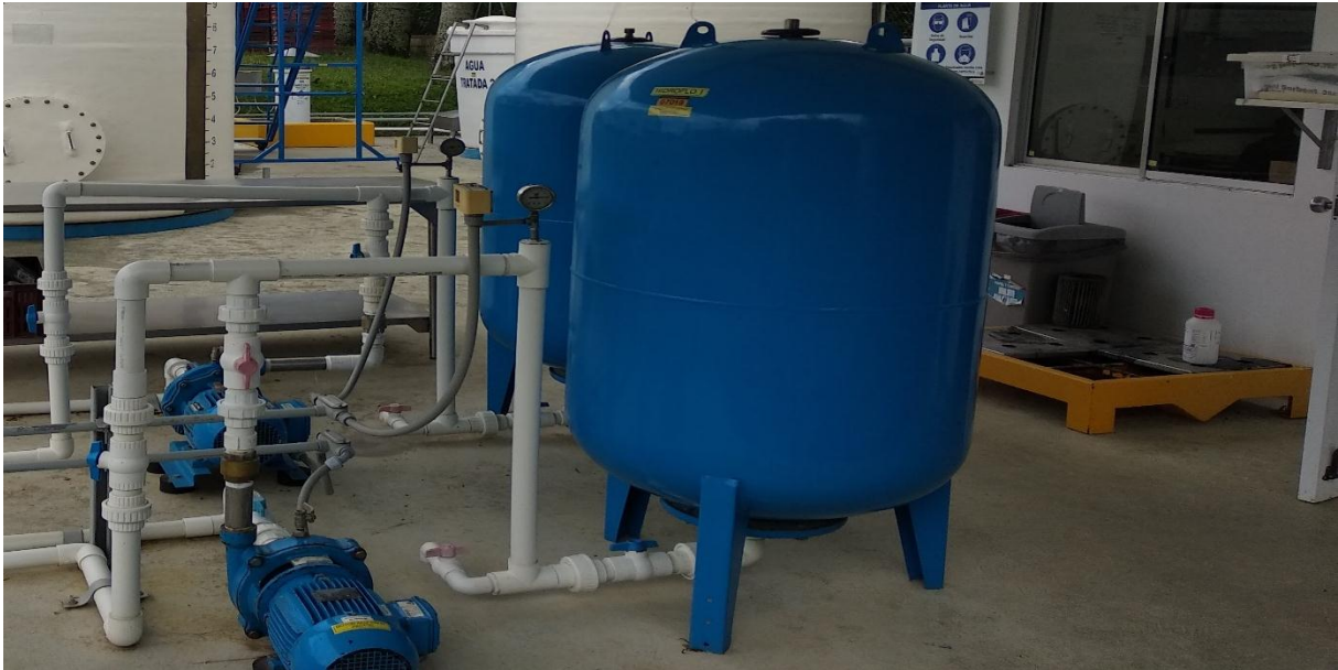
Imagen 30. Bombas de proceso y tuberías de conexiones (fuente: Autor)
