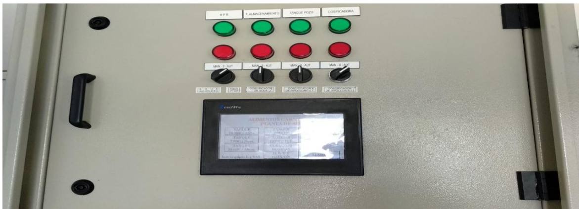
Imagen 20. Panel de operación PTAP (fuente: autor)
