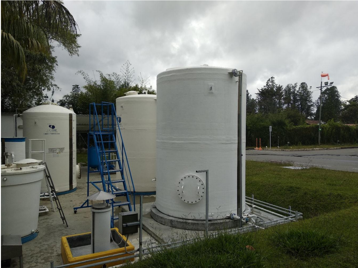
Imagen 26. PTAP después de la Automatización (fuente: Autor)
