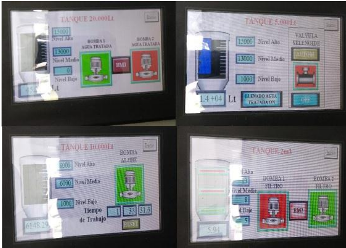
Imagen 32. Pantallas de control de cada tanque (fuente: Autor)
