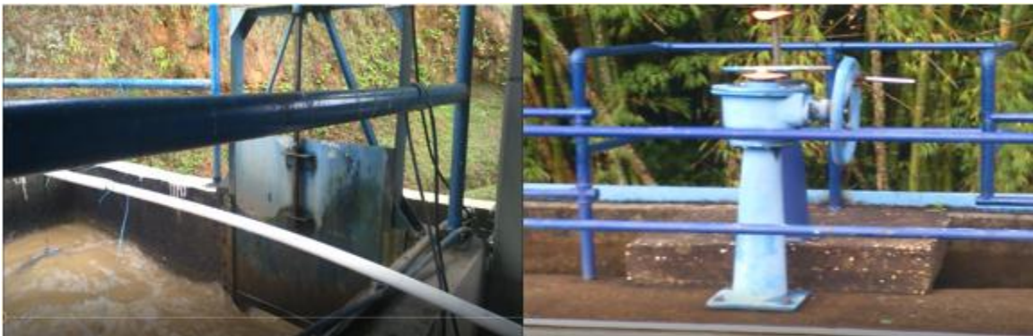
Figura 5. Válvulas tipo compuertas manuales PTAP Rionegro Antioquia.
