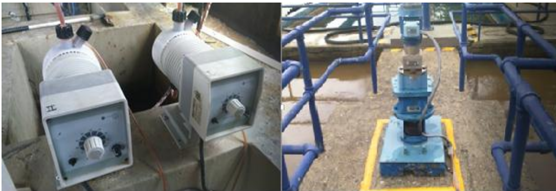
Figura 4. Dosificadores y moto reductor (Celator) manuales PTAP Rionegro Antioquia.
