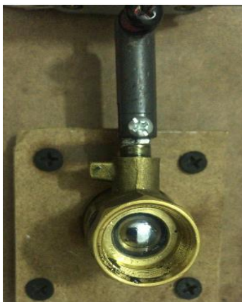
Figura 9. Válvula de globo al 0% (cerrada).
