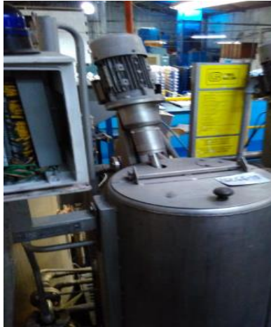
Figura 22: Tanque auxiliar y mezclador. (capturada por el autor).
