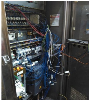
Figura 8: Tablero eléctrico Autoclave (Imagen real tomada por el autor).
