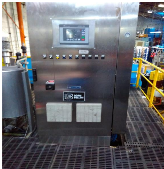
Figura 21: Pantalla implementada sedomat 1800 instalada en gabinete (realizada por el autor).
