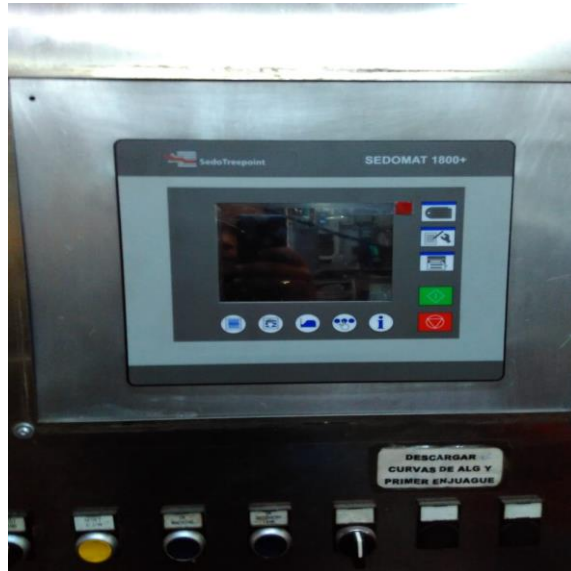
Figura 20: Pantalla implementada instalada sedomat 1800 (realizada por el autor).
