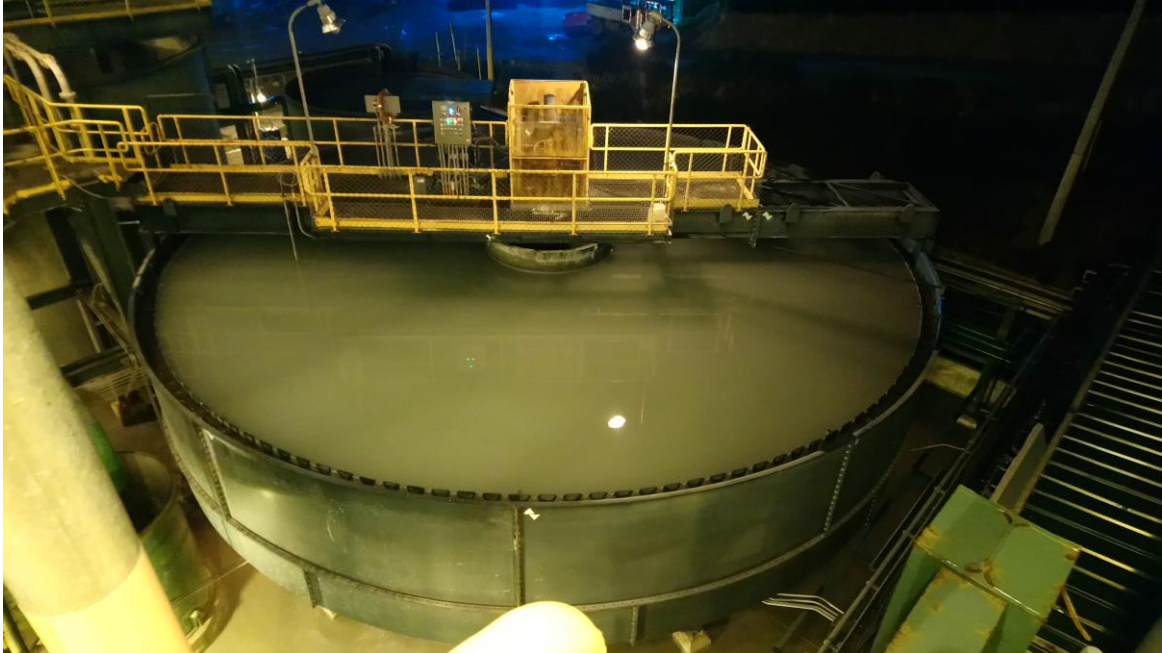
Ilustración 5. Espesador de lodos
