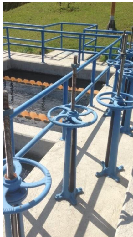
Figura 1. Sistema actual de válvulas planta de potabilización la Ceja Antioquia. (Propia).
