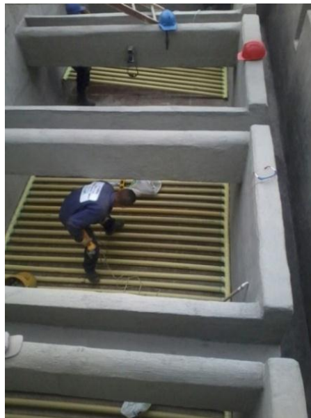
Figura 37. Malla de PVC para inyección de aire (propia).
