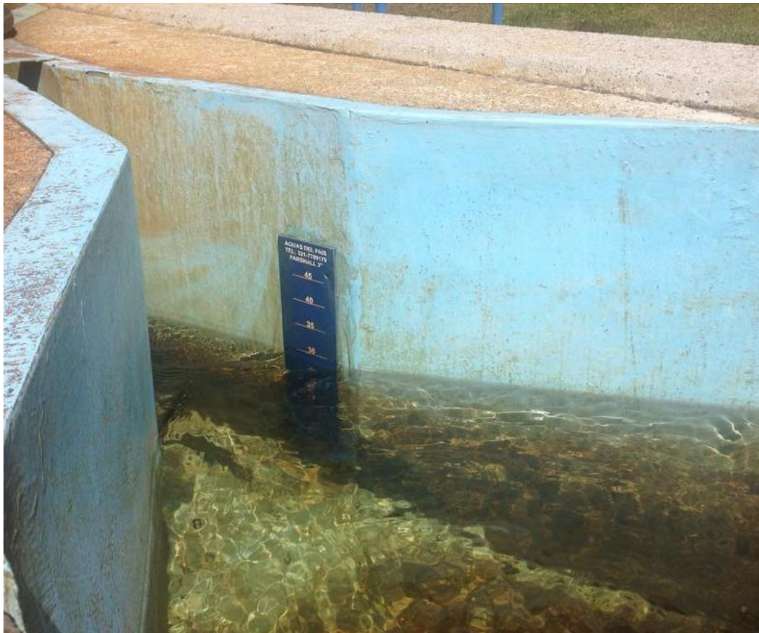
Figura 24. Zona de ingreso agua planta de tratamiento la milagrosa (Propia).
