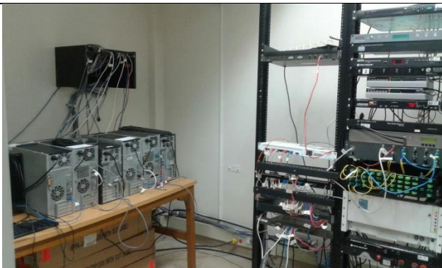
Figura 4. Cableado del rack 2 en el aula N602
