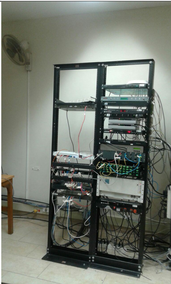
Figura 3. Cableado de la parte frontal del rack 2 en el aula N602
