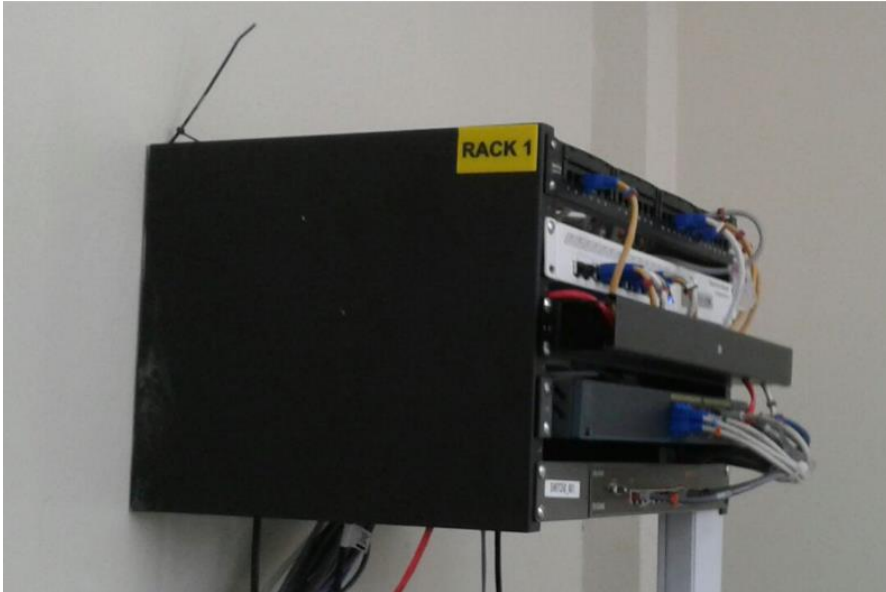
Figura 11. Rack 1 del aula N601
