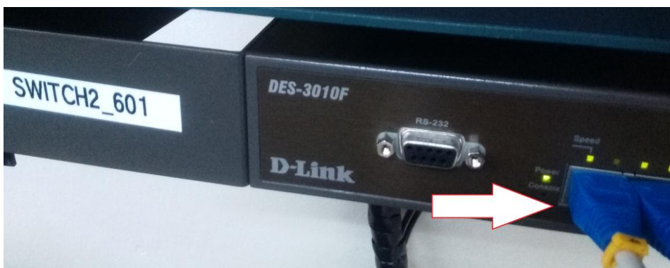
Figura 87. Puerto de conexión hacia la interfaz Wan del Pfsense. Fuente: Autor.
