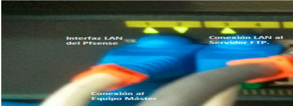
Figura 88. Puertos de conexión para la interfaz LAN del Pfsense y los demás equipos. Fuente: Autor.
