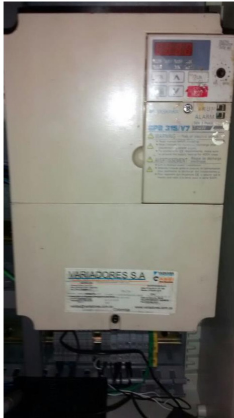
Figura 4. Variador de velocidad yaskawa GPD 315/V7
