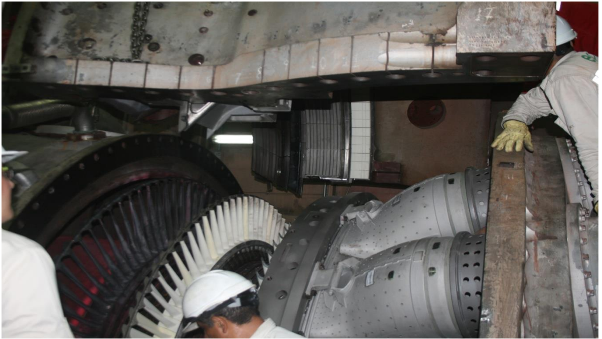
Fuente: Elaboración propia (Termoeléctrica la SIERRA) Puerto Nare 2017.
