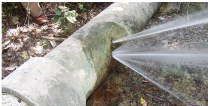
Figura 4. Fuga de agua. Fuente: https://cutt.ly/SSaoX17
