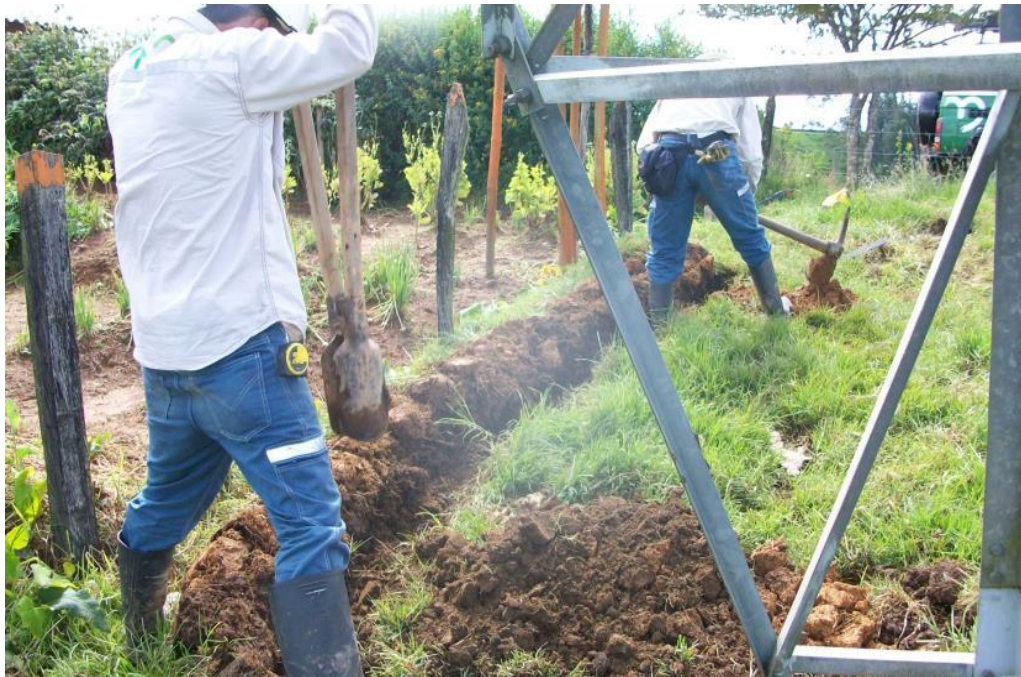
Figura 16. Instalación de compensación torre 88 (Empresas Públicas de Medellín, 2016)
