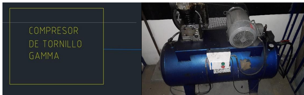
Figura 19. Compresor Gamma de la red actual (Fuente: Autores)
