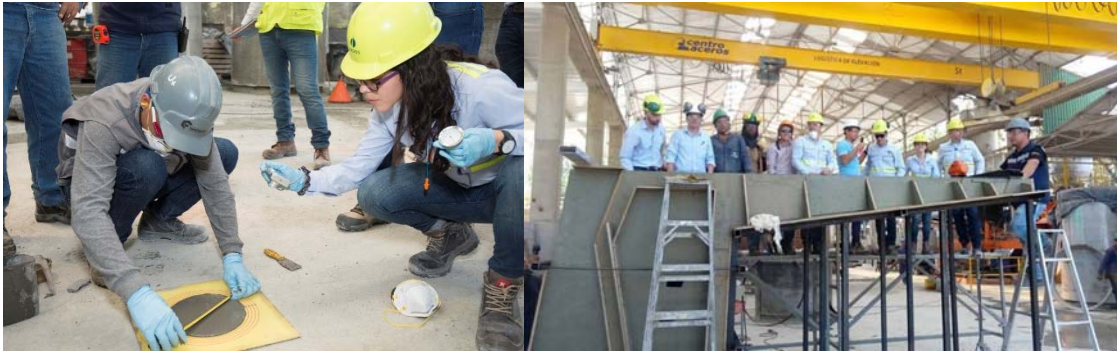
Figura. 38. Apoyo en el vaciado de prototipo de una dovela de un puente.
