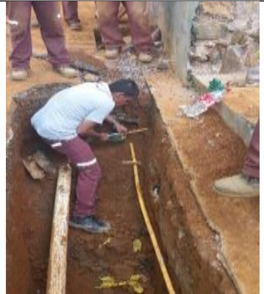
daño en la red de gas de 25mm
