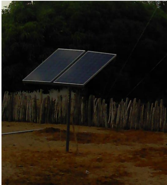
Figura 49. Paneles solares (Durespo S.A, 2010).
