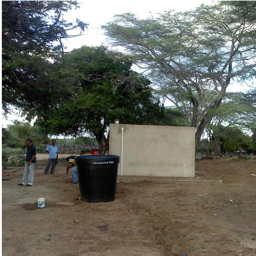
Figura 47. Tanque de almacenamiento 20 metros cúbicos. Fuente: autores.
