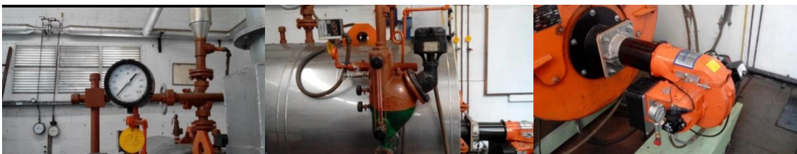
Figura 9. Instrumentos de caldera Laboratorio Operaciones unitarias de la UPB
