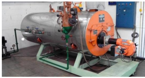
Figura 8. Caldera pirotubular 30 BHP Laboratorio de operaciones unitarias UPB
