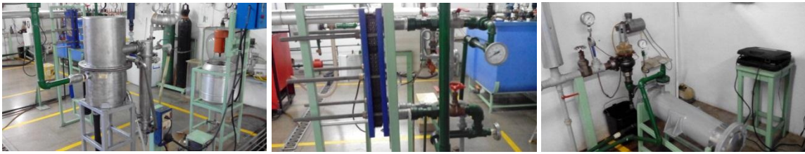
Figura 12. Bancos De Intercambiadores Tipo Serpentin, Placas Y Carcaza Y Tubos
