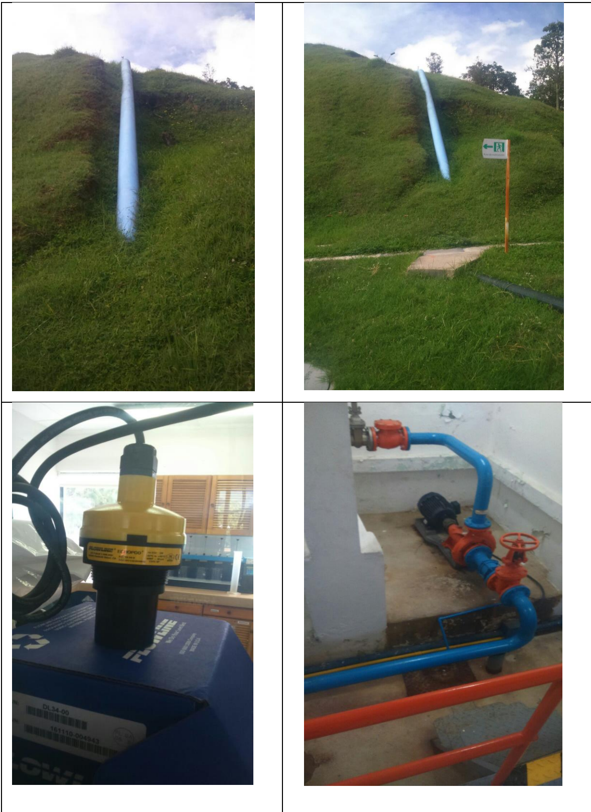
Imagen 5. Reconocimiento del Sitio y Equipos actuales. (Propia)
