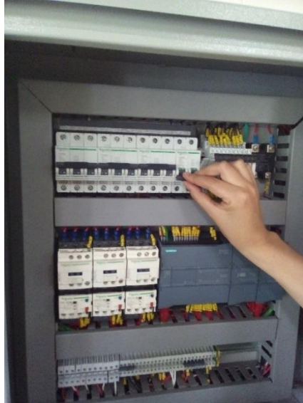
Figura 3. Breaker del gabinete de control
