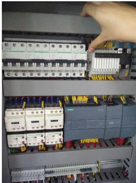
Figura 4. Fusibles de encendido del sistema de control.
