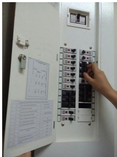
Figura 2. Breakers de encendido.
