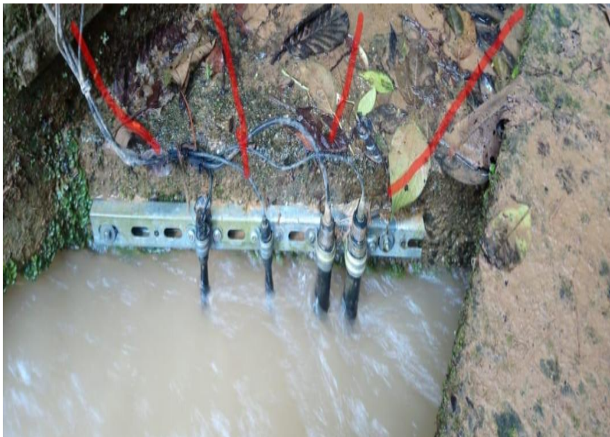
Imagen 14. Instalación mecánica sensores Análogos
