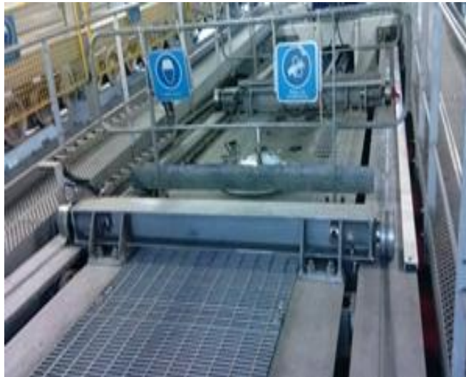
Ilustración 6. Lorry o carro de tensión. Fuente (Central de tensión estación San Javier)
