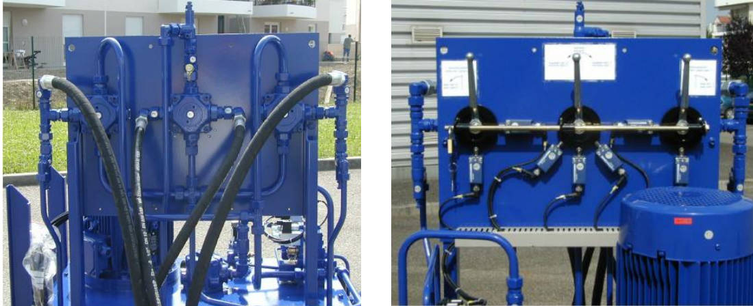
Ilustración 12. Sistema de recuperación de cable. Fuente (Central de tensión estación San Javier)
