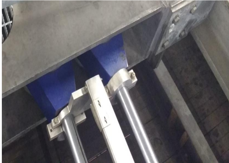
Ilustración 10. Dispositivo final de carrera. Fuente (Central de tensión estación San Javier)
