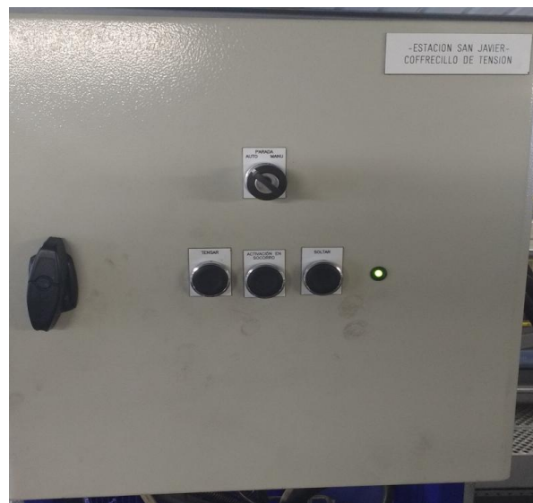
Ilustración 11. Cofrecillo de control manual. Fuente (Central de tensión estación San Javier)
