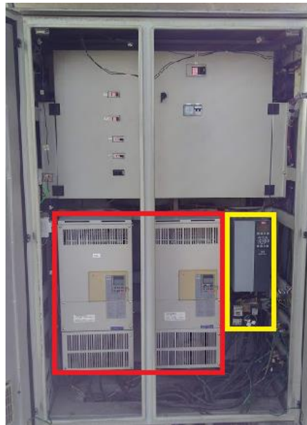
Ilustración 27 tablero de control torre de enfriamiento. Fuente, los autores.
