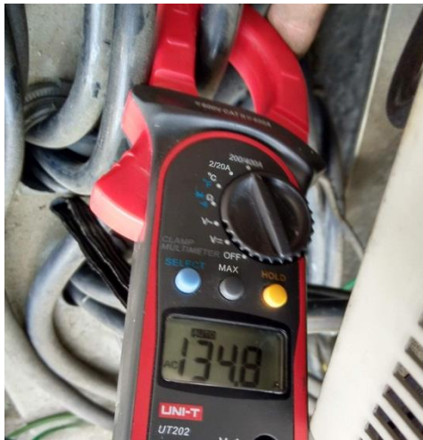
Ilustración 2 Toma de corriente en bomba de torre de enfriamiento. Fuente, los autores.
