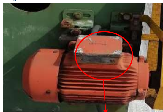
No se puede verificar conexiones ambos extractores
