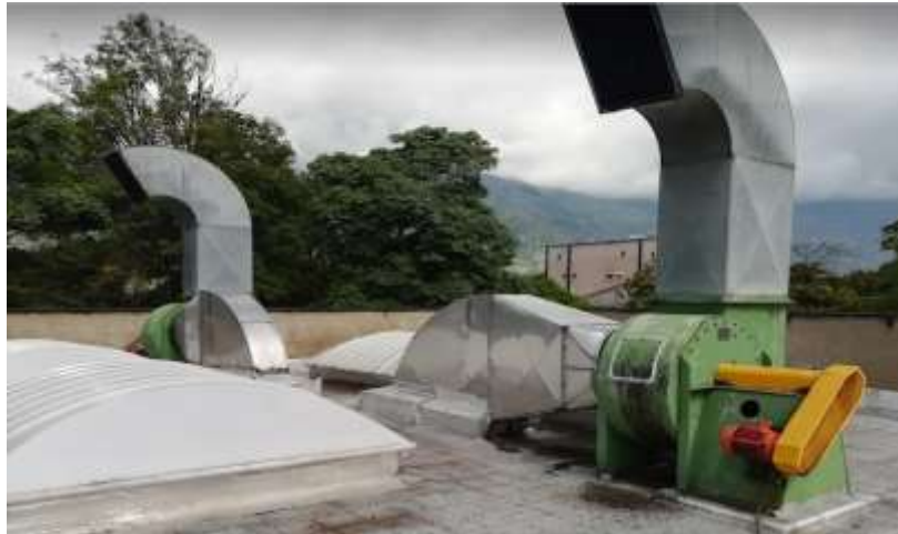
Imagen 37. Campanas de extracción
