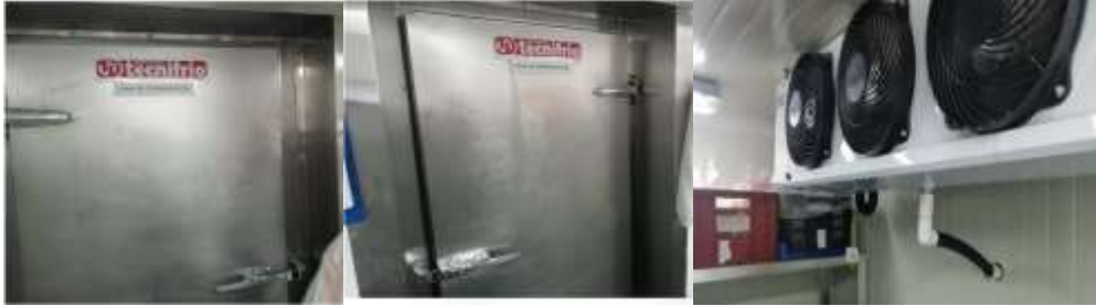
Imagen 20. sistemas de refrigeración y congelación (cavas)
