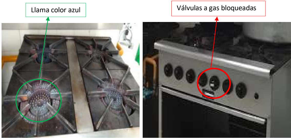
Imagen 64. Estufa 4 puestos # 1 industrial con averías
