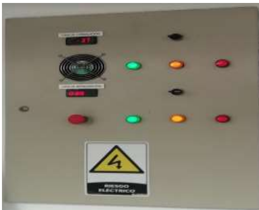
Imagen 32. Tablero de control cava
