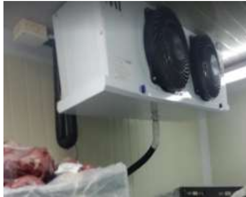
Imagen 31. Evaporador de cava
