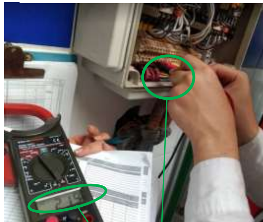
Imagen 43. Medición tablero extractores
