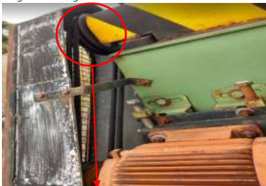
Banda motor mal estado en ambos extractores
