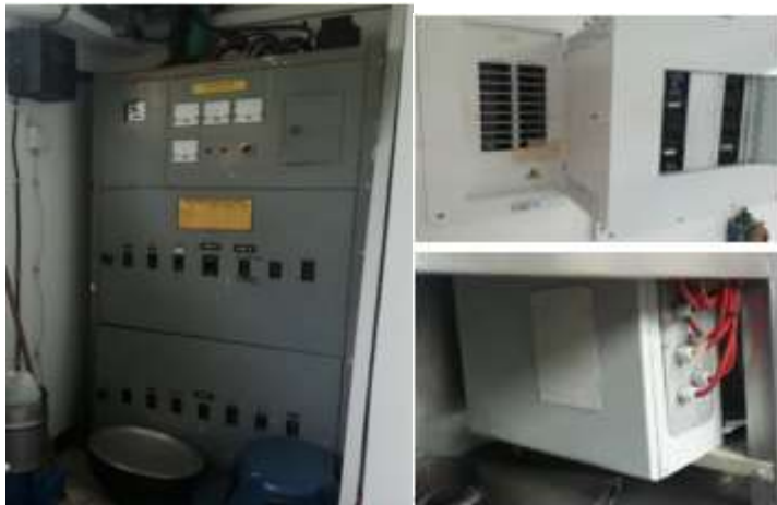
Imagen 23. Tableros de potencia
