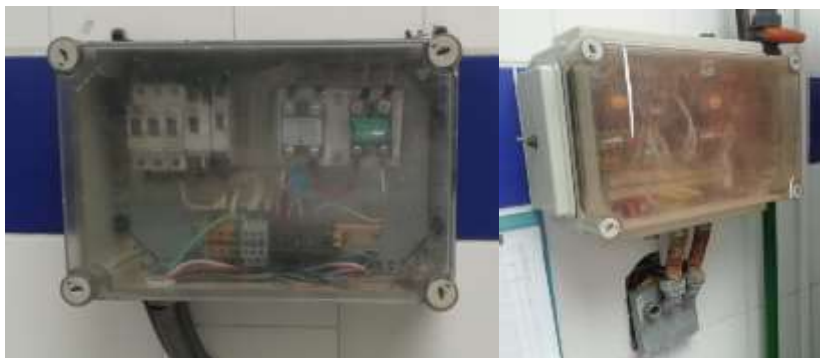
Imagen 24. Tableros de control de campabas de extracción
