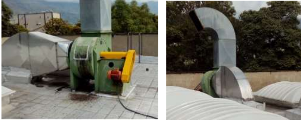
Imagen 22. Campanas de extracción
