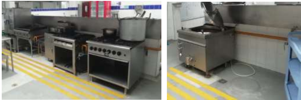
Imagen 73. Equipos de gas
