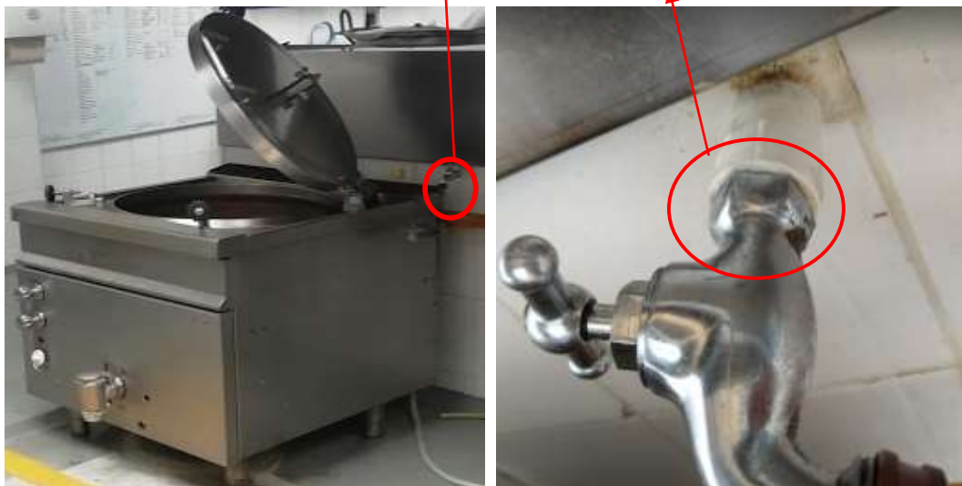
Imagen 62. Marmita a gas industrial fuga de agua
