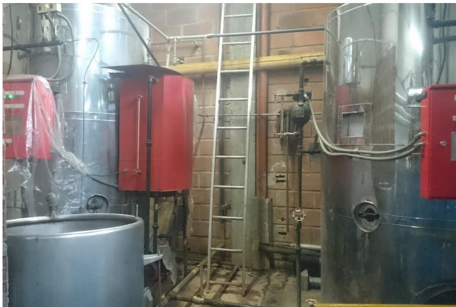
Figura 57. Cuarto de calderas (Cortesía Textiles ARRO SAS)
