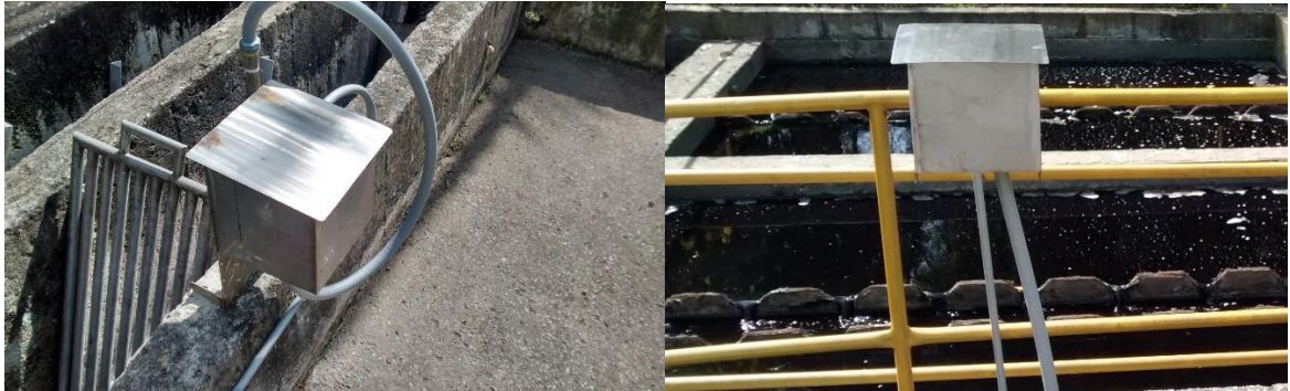
Figura 21. Guardas de protección. Tomada por el autor.
