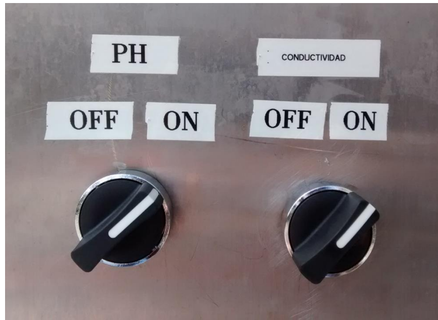
Figura 23. Tablero eléctrico. Tomada por el autor.
