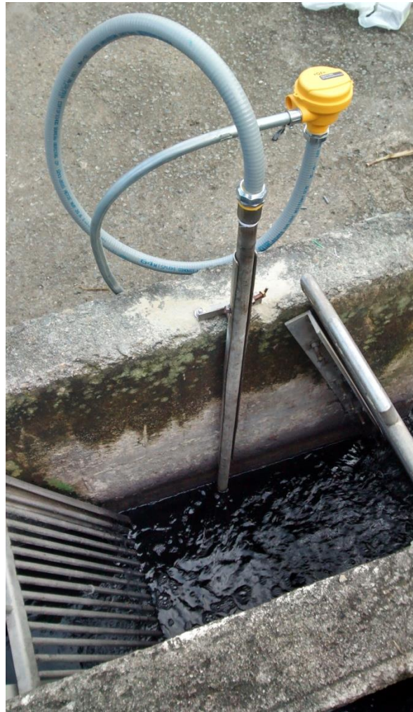
Figura 19. Instalación en línea electrodo de conductividad. Tomada por el autor.
