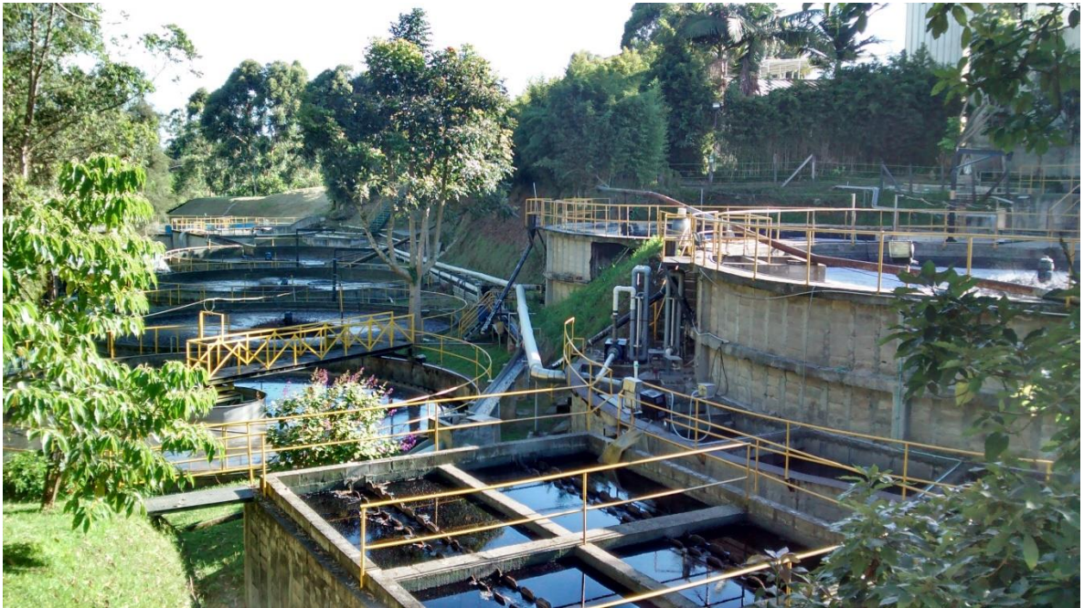
Figura 9. Planta de tratamiento de aguas residuales. Tomada por el autor.
