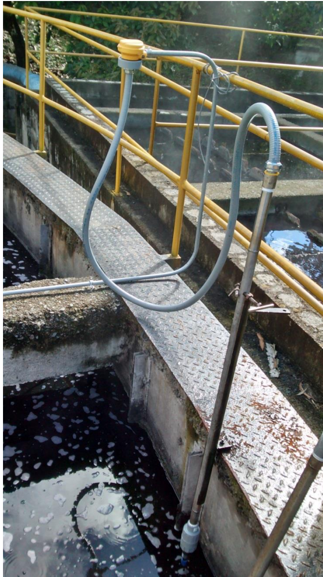
Figura 20. Instalación en línea electrodo de pH. Tomada por el autor.
