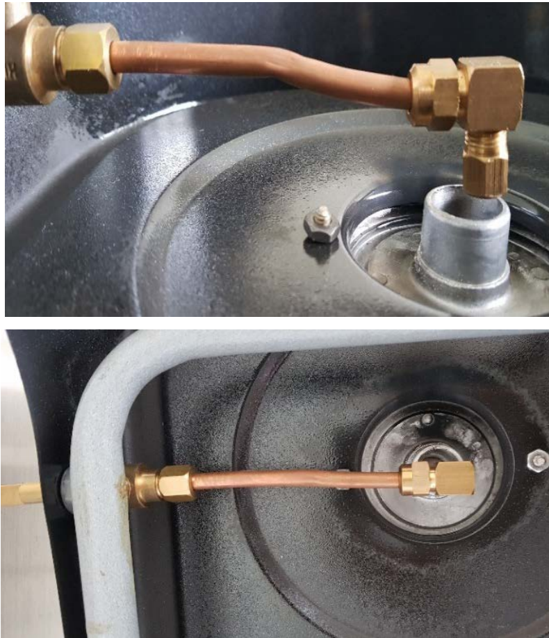
Figura 29. Detalle del Venturi en quemador modificado.
