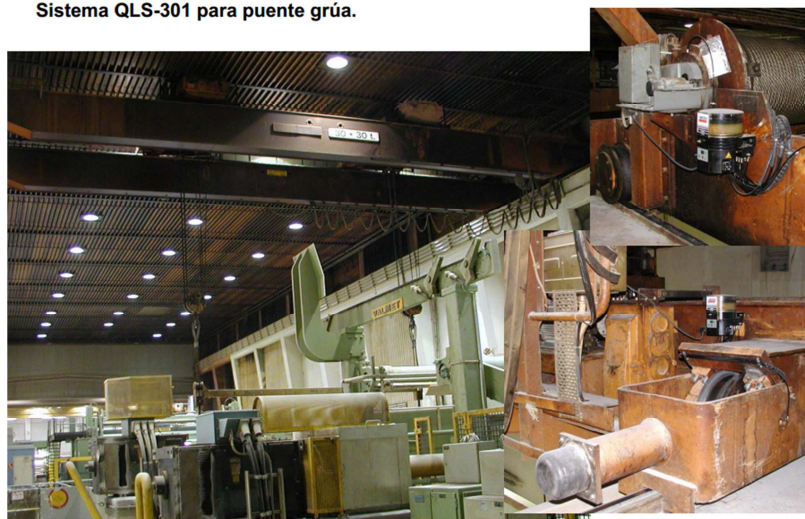
Imagen 21. Sistema QLS-301 para puente grúa (Sistemas de lubricación Lincoln en la industria papelera, 2013)
