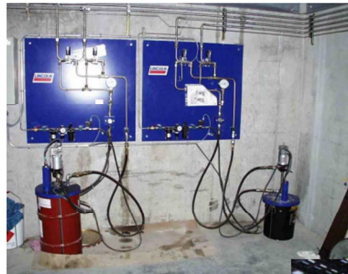
Estación de bombeo para guillotina Zona seca / Zona húmeda (La LISA está aparte)
