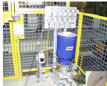
Multilínea-CLS para bobinadora (110 puntos de grasa, aprox.)
