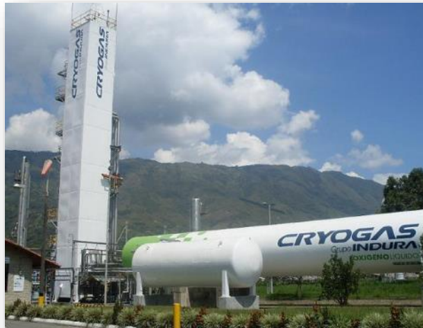
Figura 14: Tanques criogénicos de Planta ASU – Barbosa
