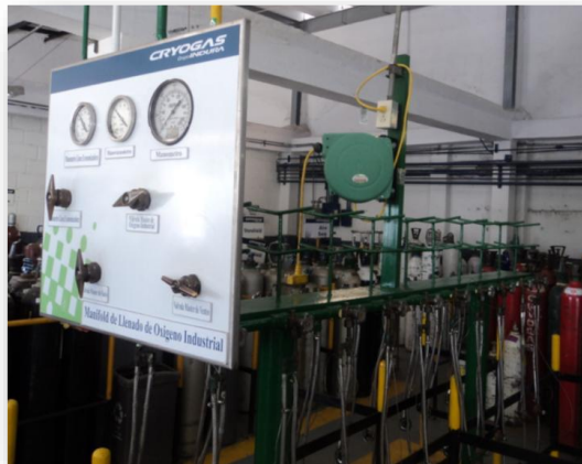
Figura 21: Válvulas Master de Manifold de cilindros
