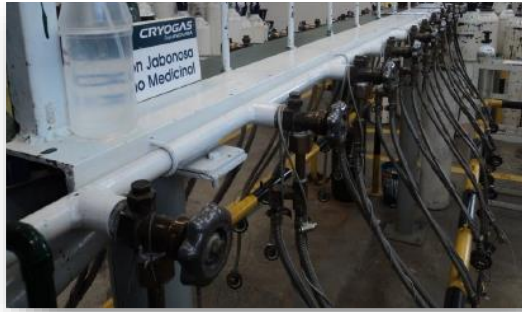
Figura 18: Tubería de Manifold de Cilindros
