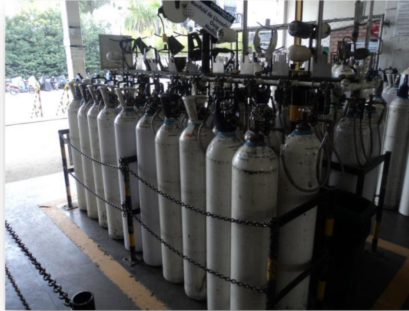
Figura 22: Manifold de cilindros de Oxígeno
