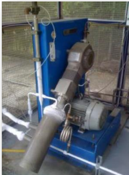
Figura 15: Bomba reciprocante PD3000 ubicada en Cryogas Sabaneta
