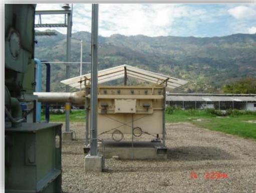
Figura 4: Filtración de aire ambiente
