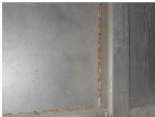
b. Imagen tomada en una compuerta instalada en la PTAR Bello
