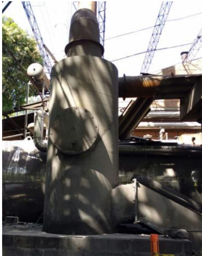
Imagen 9, Lavador de gases con el que cuenta la empresa TINTURAS Y TELAS S.A., el cual está en uso para la caldera china EPCB.
