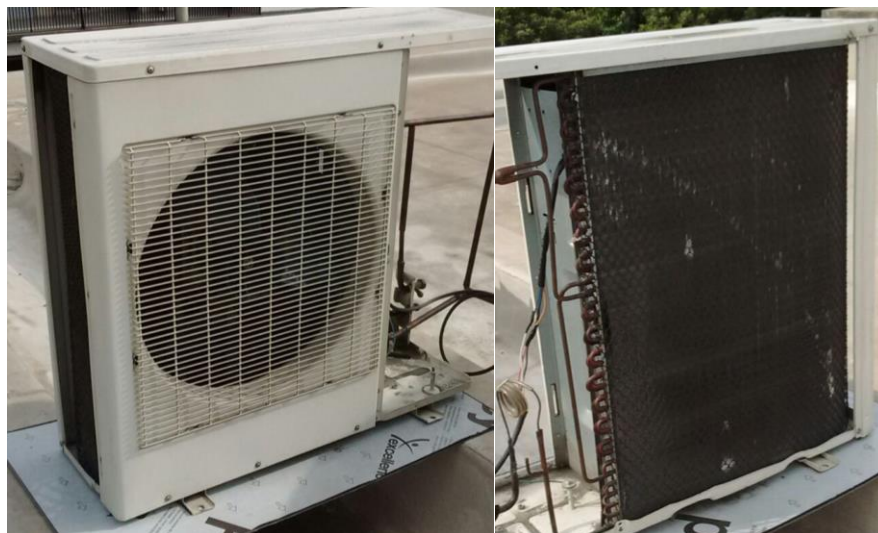
Figura 35. Evaporador. Fuente propia.
