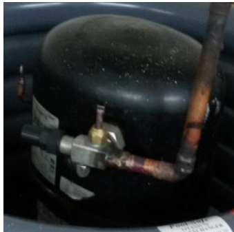
Figura 32. Compresor. Fuente propia.
