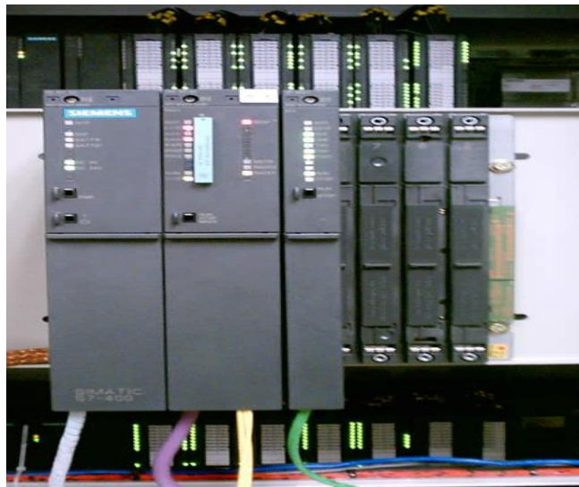
Figura 26. PLC con sus Conexiones. Fuente: Propia.
