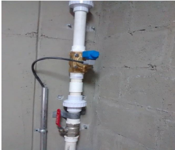
Figura 20. Válvula Instalada en la Red del Tanque 2. Fuente: Propia.
