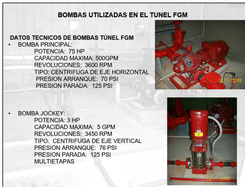
Figura 4. Sistema de Bombeo de la Red Contra Incendios, Cuarto de Bombas.
