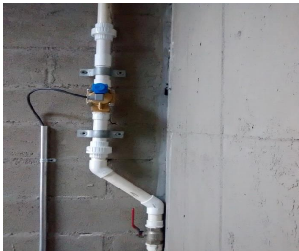
Figura 19. Válvula Instalada en la Red del Tanque 1. Fuente: Propia.
