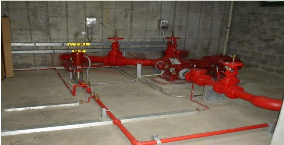
Figura 15. Sistema de Bombeo de la Red Contra Incendios. Fuente: Propia.
