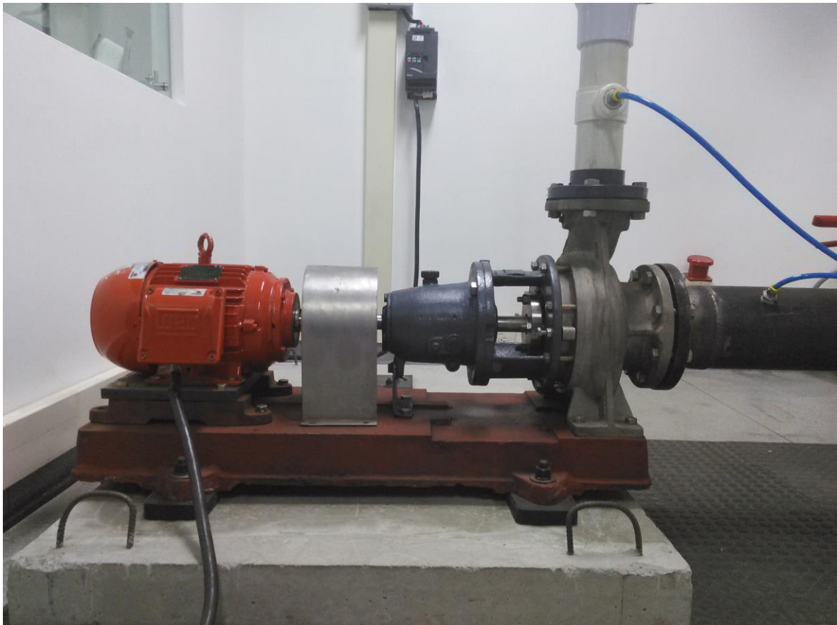
Figura 3- 1: Bomba centrífuga de 10 HP.
