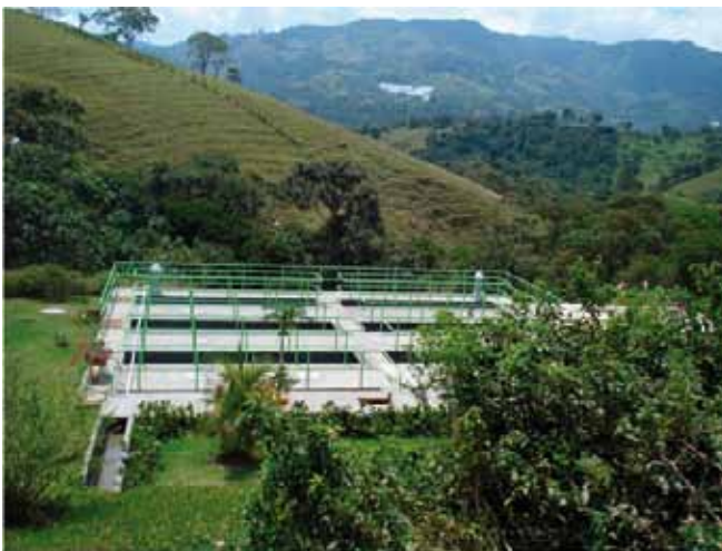
Planta de Tratamiento de aguas residuales. Municipio de Jericó (Antioquia-Colombia)
