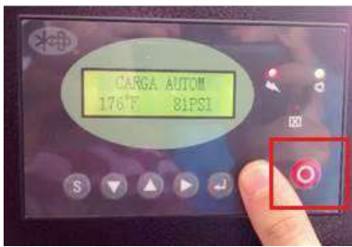
Imagen 10.1. Apagado del compresor.
