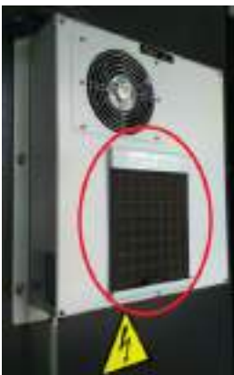
Imagen 2. Maya del intercambiador de calor.
