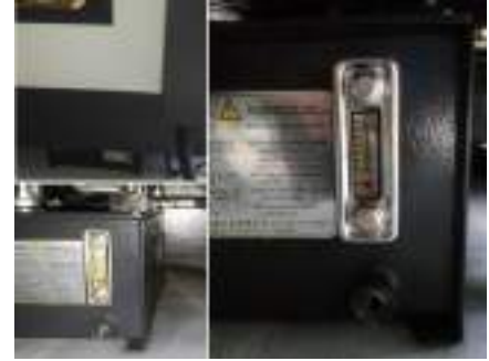
Imagen 6. Nivel tanque hidráulico.
