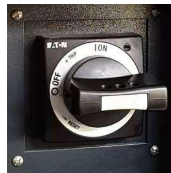
Imagen 8. Interruptor principal en "OFF"
