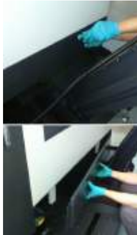
Imagen 3.1. Cubierta de los motores del sistema refrigerante.
