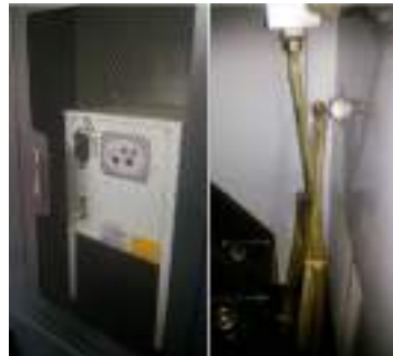
Imagen 5. Sistema de refrigeración del aceite hidráulico.
