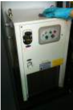
Imagen 3.1. Limpiar el exterior del radiador.
