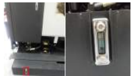
Imagen 9. Nivel tanque de refrigerante.
