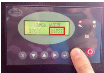
Imagen 2.1. Encendido del compresor.
