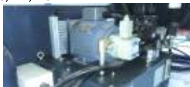
Imagen 4.3. Motor del tanque hidráulico.
