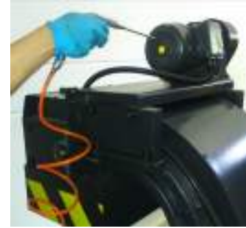
Imagen 1.6. Limpieza del ventilador.
