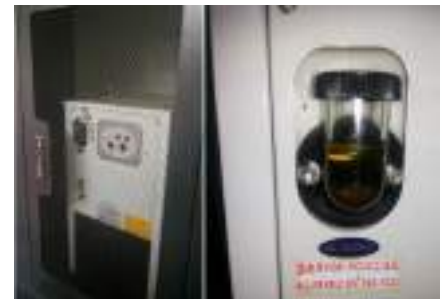
Imagen 8. Nivel del sistema de refrigeración del aceite hidráulico.
