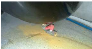
Imagen 1. Válvula drenado de tanque compresor
