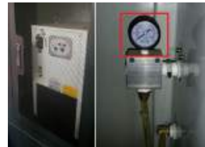
Imagen 11. Manómetro sistema de refrigeración del aceite hidráulico.
