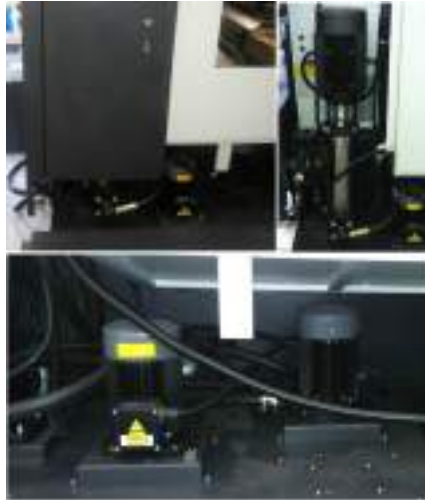
Imagen 3. Bombas de lubricación.
